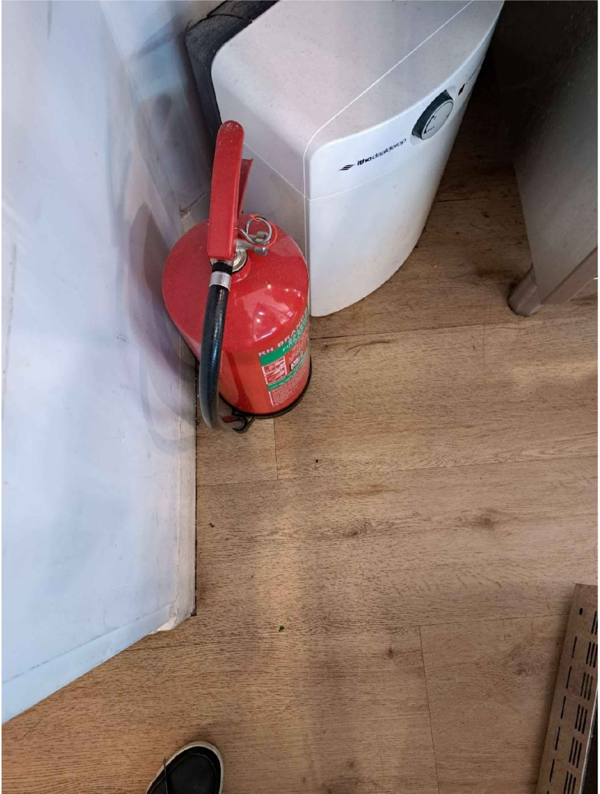
Foto gemaakt op 27-3-2025. Brandblusser staat los is niet opgehangen.
