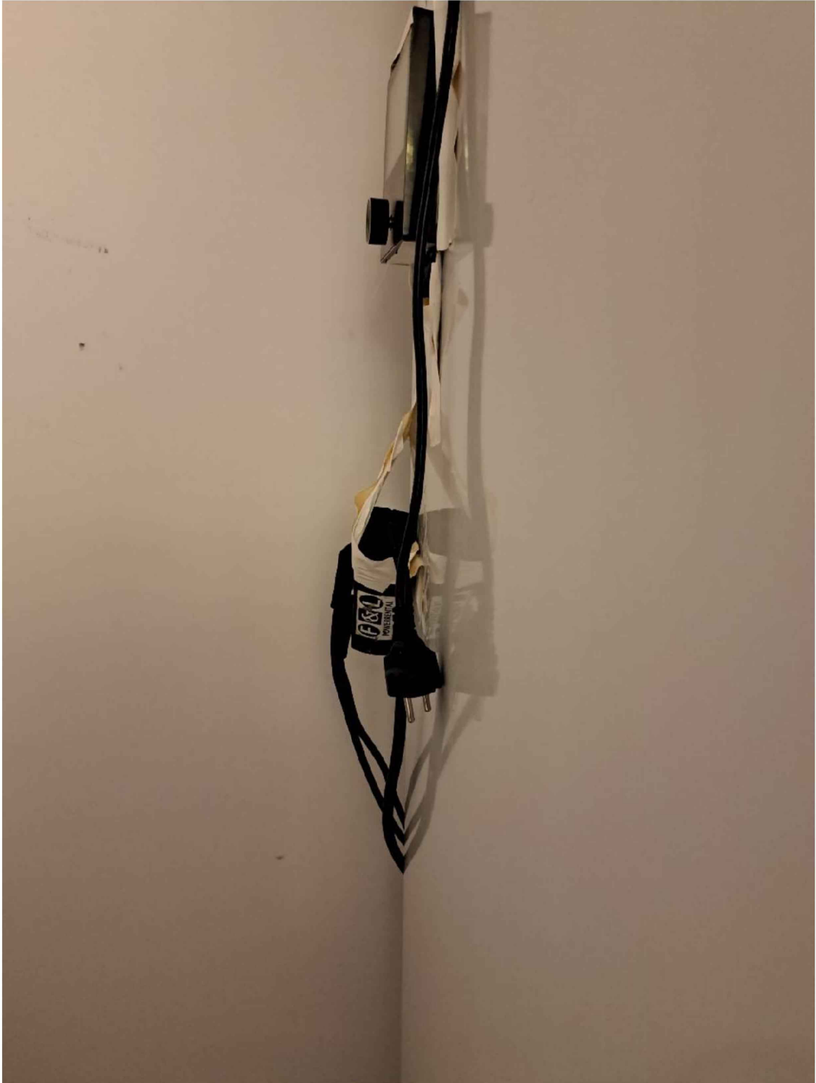
Foto gemaakt op 27-3-2025. Gebruik van een stekkerdoos.
