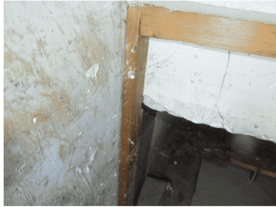
Restanten aan de aanwezige spijkers
