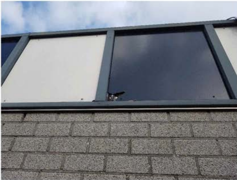
Ruimte achter dekplaten soms toegankelijk door schade
