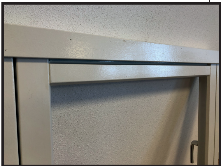
Ventilatierooster niet te zien vanaf de buiternzijde
