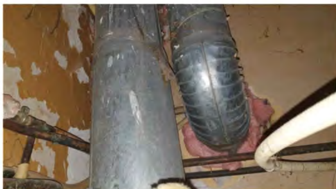
F04 Andreas Bonnstraat 15H Metalen buizen boven het plafond van de keuken
