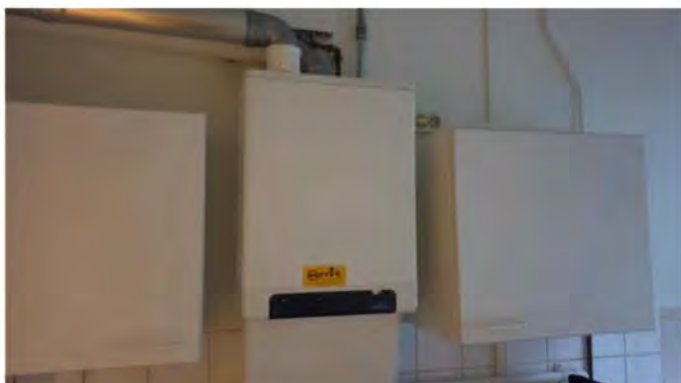
F15 Andreas Bonnstraat 9H Niet asbestverdachte cv- ketel
