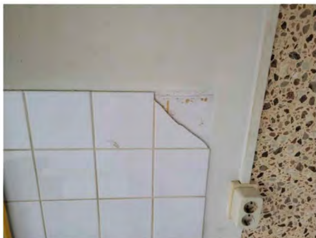
F18 Andreas Bonnstraat 15-2 Recent aangebracht tegelwerk
