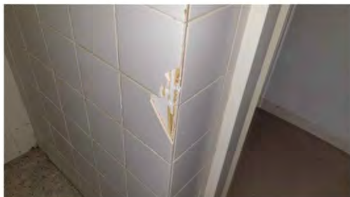
F9 Andreas Bonnstraat 15-3 Recent aangebracht tegelwerk
