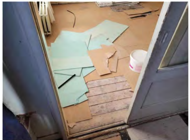
F17 Andreas Bonnstraat 15-2 Buiten de slaapkamer zijn geen vinyltegels met lijmlaag aangetroffen
