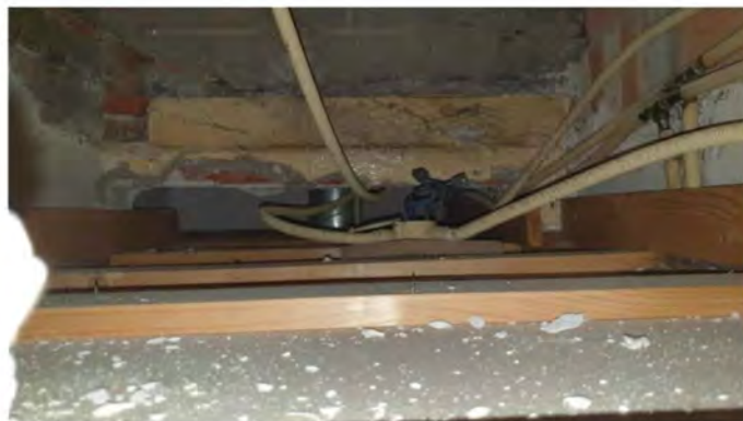
F03 Andreas Bonnstraat 15H Metalen buizen boven het plafond van de keuken
