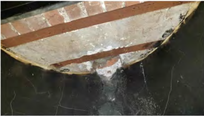
F11 Andreas Bonnstraat 9H Geen asbestverdachte toepassingen ter hoogte van de schouw
