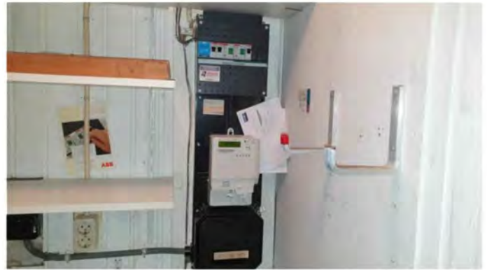
F12 Andreas Bonnstraat 9H Niet asbestverdachte technische installatie
