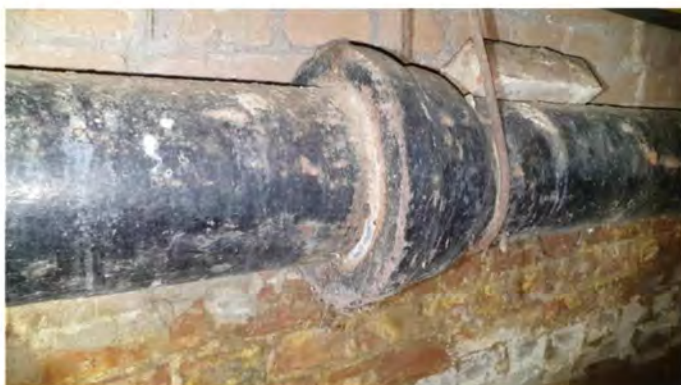
F08 Andreas Bonnstraat 15H De gietijzer verbinding van de riolering is afgedicht met lood
