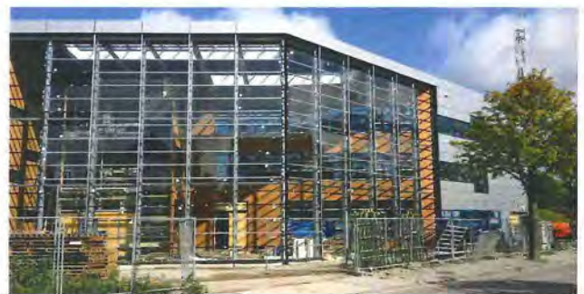
Klimaatneutrale nieuwbouw Huygens College en praktijkschool De Polstak; gebouw Focus door het consortium
