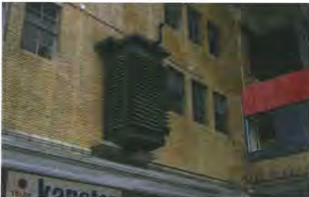
Hergebruik oorspronkelijke luchtverwarmers voor afvoer van warmte door productierij in winkels en horeca
