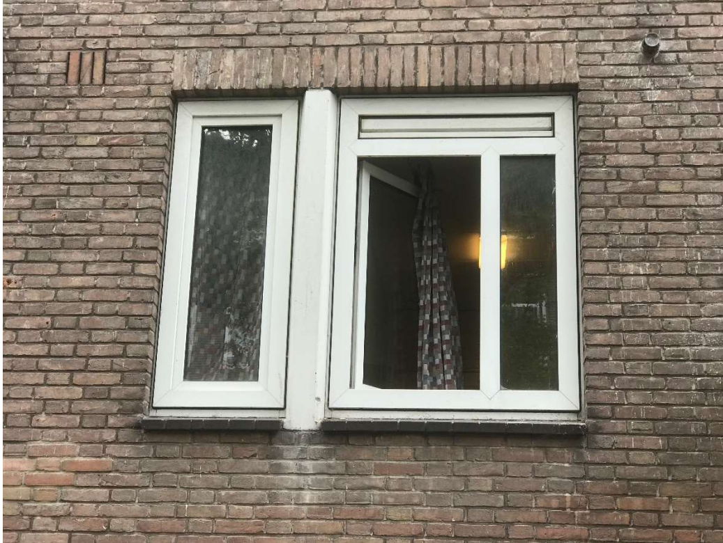
Figuur 2.10: Kunststof kozijnen met dubbele beglazing en ventilatieroosters in alle gevels.
