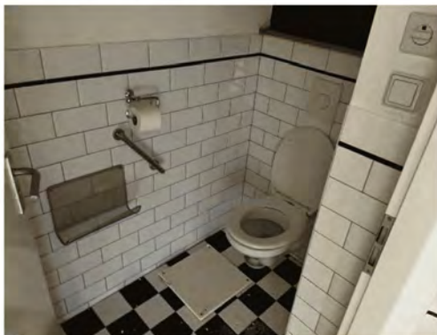
Foto 43: Tegellijm: niet asbestverdacht
