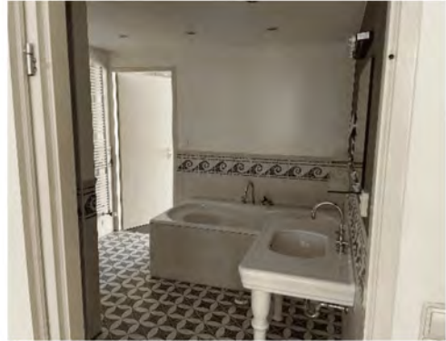
Foto 48: Tegellijm: niet asbestverdacht
