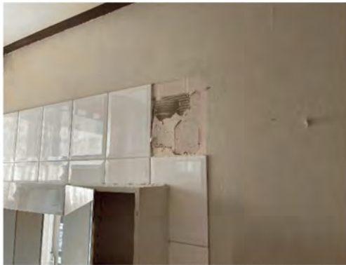
Foto 55: Tegellijm: niet asbestverdacht
