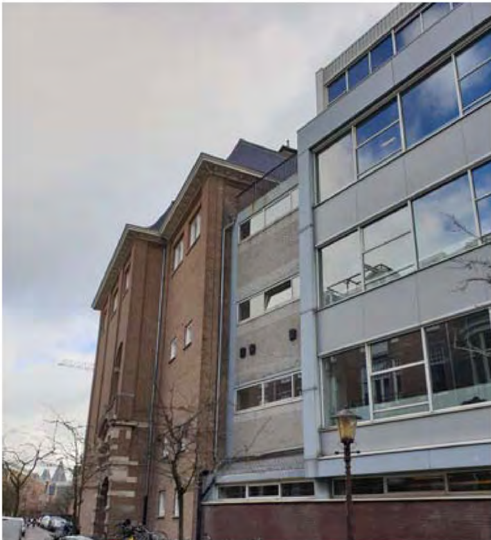
foto van de aansluiting van gebouw A op gebouw B, gezien vanuit de Pieter de Hoogstraat
