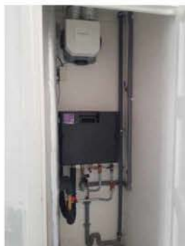
Kast met mechanische ventilatie en stadswarmte-unit
