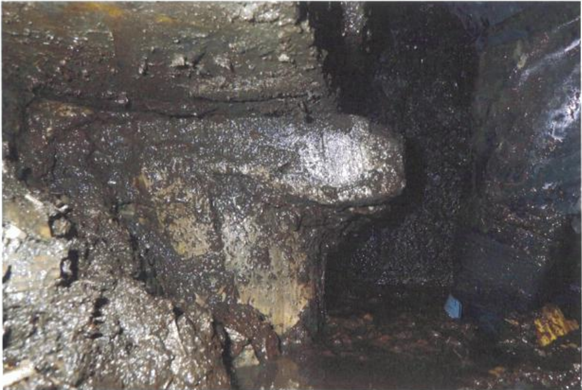
langshout 1, kesp 2 en paal 2 (kesp 2 is 50% samengedrukt)
