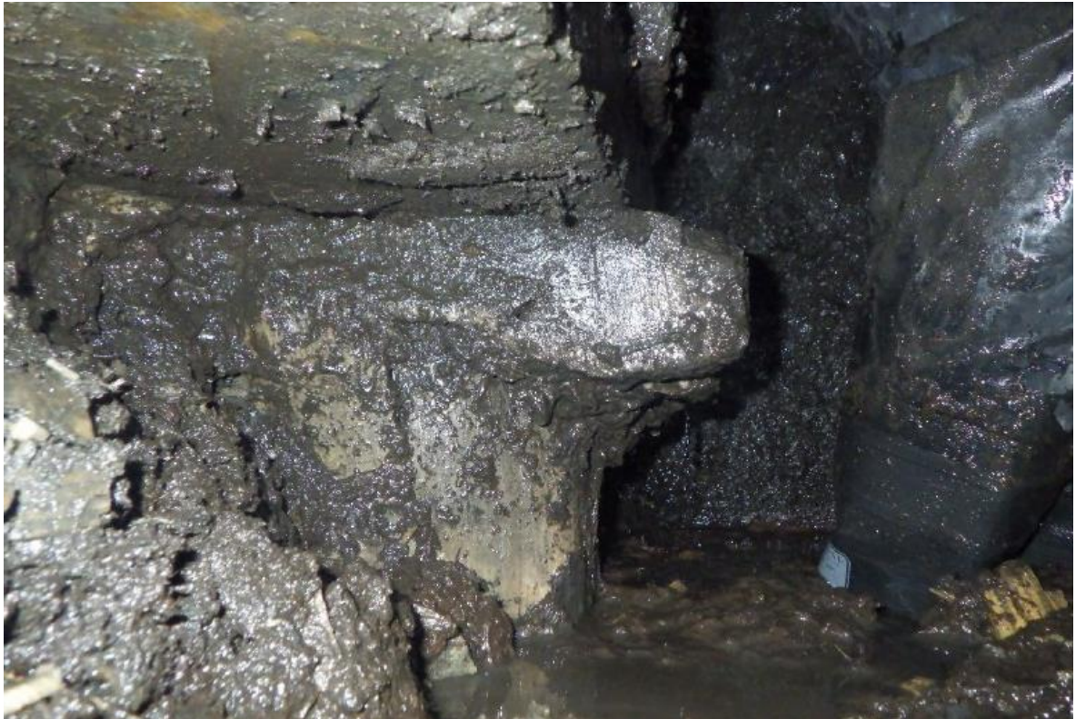
langshout 1, kiesp 2 en paal 2 (kiesp 2 is 50% samengedrukt)
