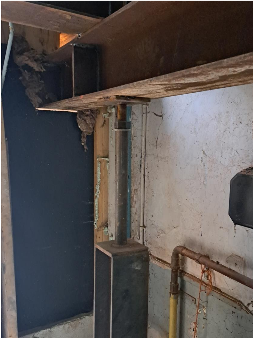
Foto van de huidige staat van de tafelconstructie aan de zijde van no.38. Deze constructie is in de huidige staat niet geschikt om de bouwmuur te dragen. Hiertoe zijn de bovengenoemde voorzieningen benodigd.
