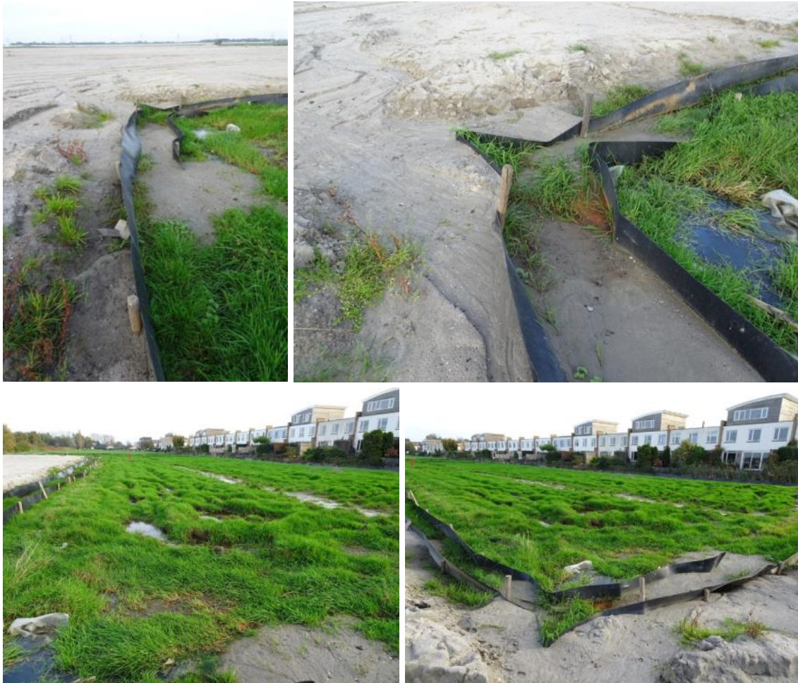
Figuur B2.5 De functie van het scherm, namelijk het voorkomen dat rugstreppadden en heikikkers het opgespoten terrein weer kunnen oplopen, functioneert in de huidige situatie niet. Doordat het scherm niet overal de vereiste hoogte van 50 cm heeft en op sommige plaatsen slechts enkele centimeters, kunnen de amfibieën vanuit het omliggende veld zo weer het terrein oplopen.
