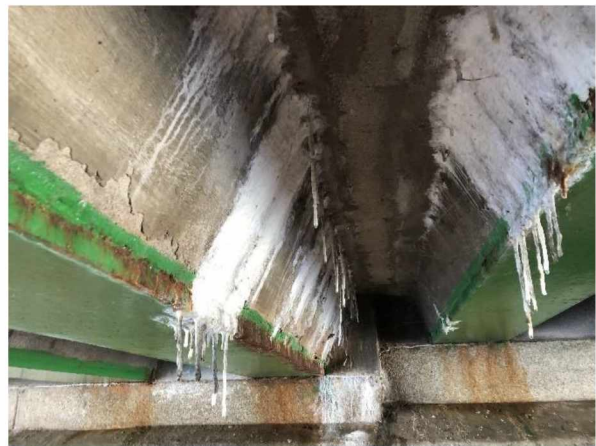
Foto 8: Leckage vanuit langscheuren in hoeken betonoppervlak.
