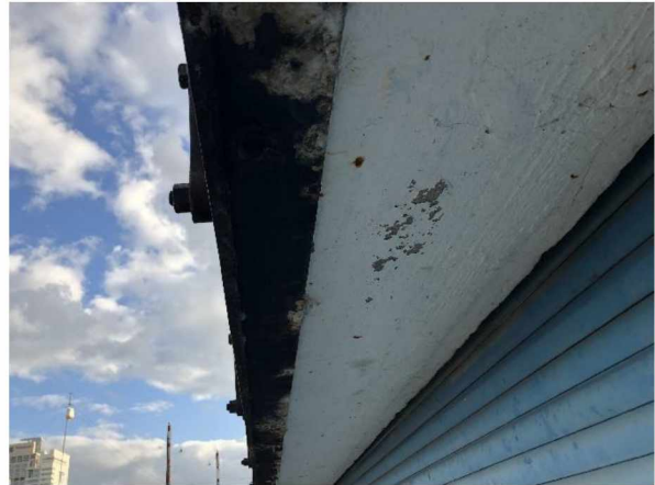
Foto 26: Afbladderende coating ter plaatse van het plafond buiten de box.
