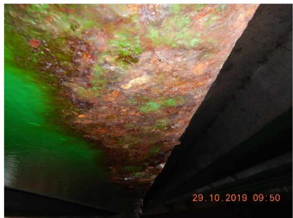
Foto 4: Zware corrosie stalen ligger.
