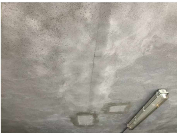
Foto 17: Scheur in plafond.
