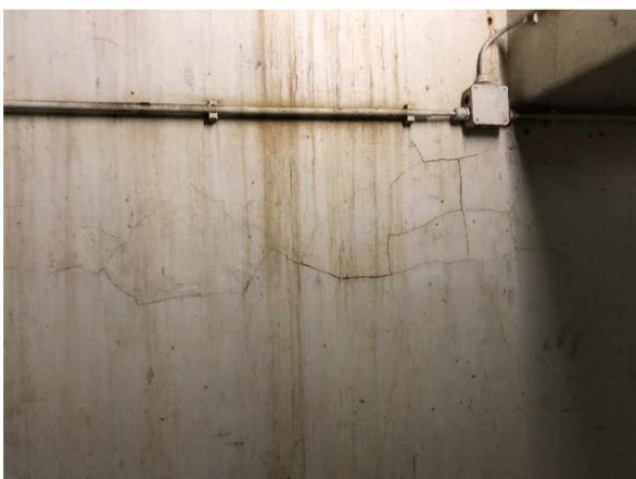
Foto 45: Scheuren in afwerklaag en/of reparatie van wand.
