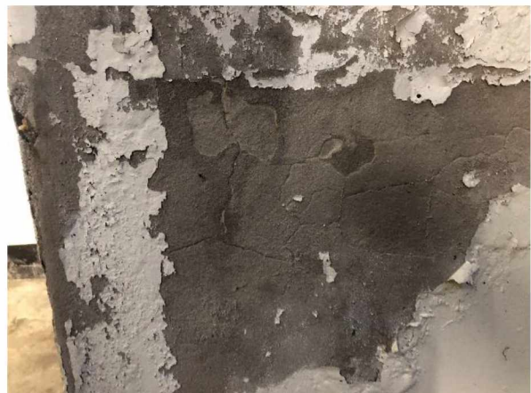
Foto 44: Afbladderende coating en scheuren in afwerklaag in wand.
