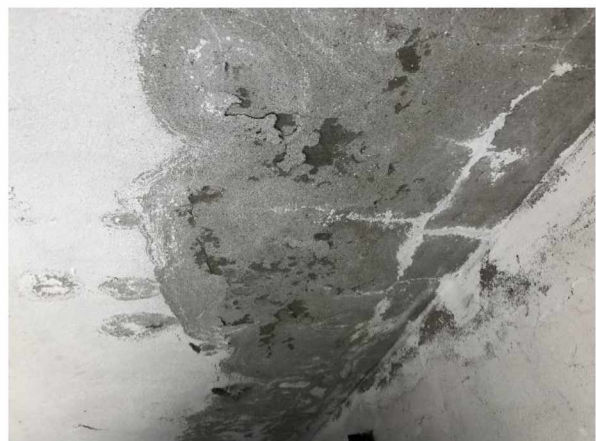
Foto 30: Scheurtjes en losliggende delen in afwerklaag plafond.
