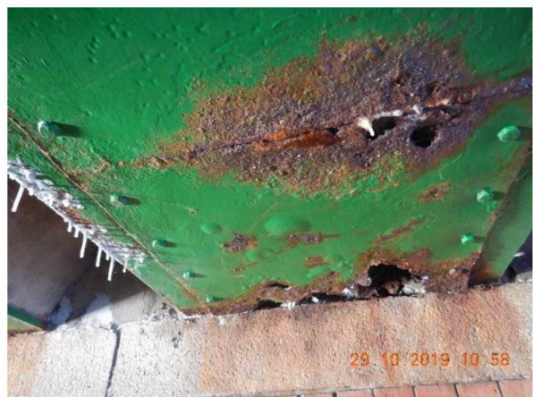
Foto 6: Zware corrosie afdekplaat, plaatselijk geheel doorgeroest.
