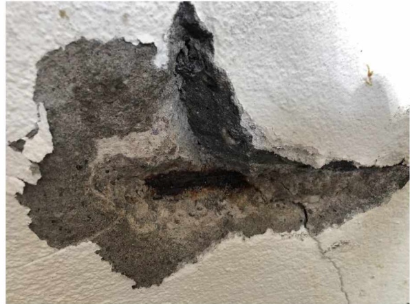
Foto 42: Afgedrukt beton + afwerklaag met blootliggende gecorrodeerde wapening in wand.
