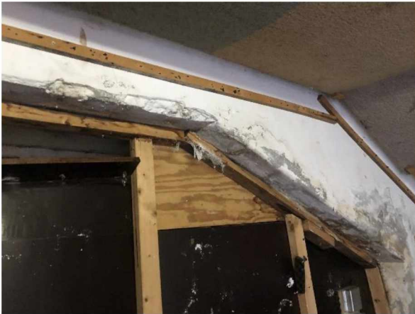
Foto 31: Afgebrokkelde afwerklaag balk.
