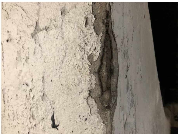
Foto 43: Deels verdwenen afwerklaag op hoek van wand.
