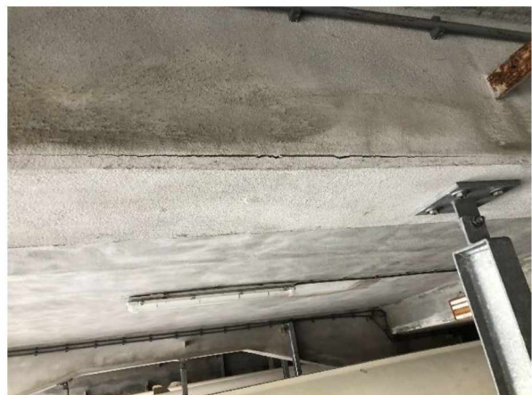
Foto 24: Opmerkelijke rechte scheur in afwerklaag van kolom.
