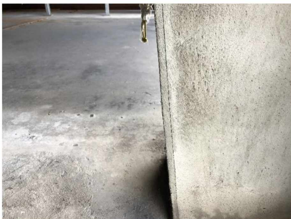
Foto 23: Opmerkelijke rechte scheur in afwerklaag van kolom.
