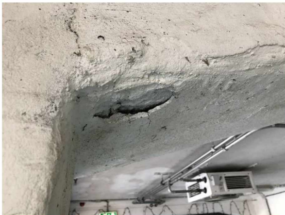
Foto 21: Deels losliggende afwerklaag onderzijde balk.
