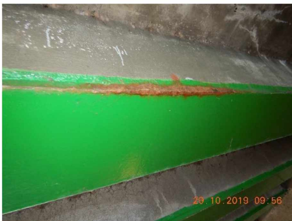
Foto 3: Lichte corrosie stalen ligger.
