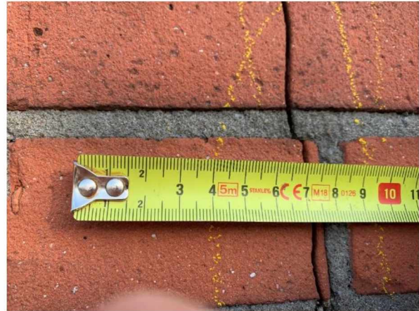
Foto 36: Detail verticale scheur zuidzijde. Scheurwijdte circa 2 mm.
