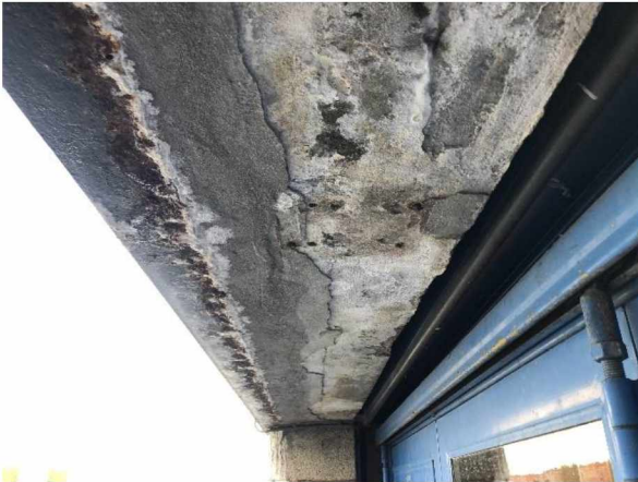
Foto 13: Afwerklaag deels verdwenen plafond buiten bij ingang.
