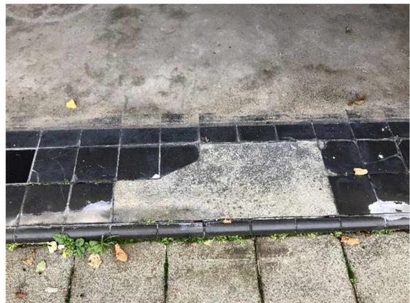
Foto 28: Gescheurde en verdwenen tegels.
