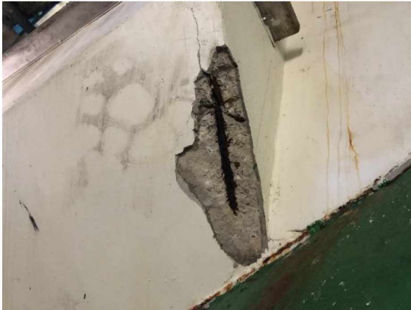
Foto 41: Afgedrukt beton + afwerklaag met blootliggende gecorrodeerde wapening.
