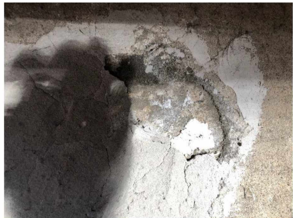
Foto 10: Losse en deels verwijderde reparatiedeel. Constructiebeton zichtbaar hieronder.
