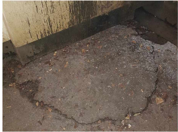
Foto 48: Losliggende schol bovenzijde vloer laatste verdieping.
