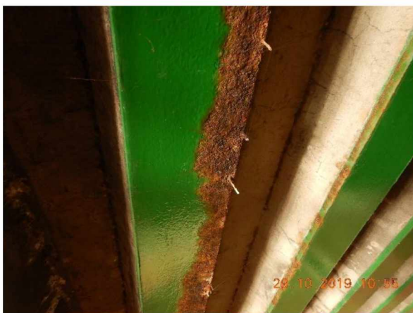
Foto 5: Zware corrosie stalen ligger.
