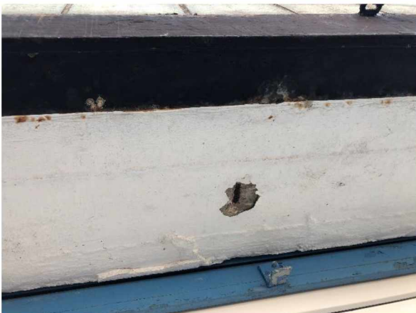
Foto 27: Afgedrukt beton met blootliggende wapening.
