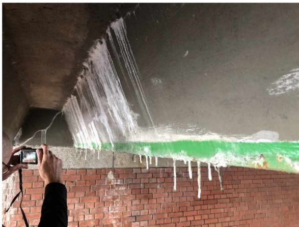
Foto 7: Leckage vanuit langscheuren in hoek betonoppervlak.
