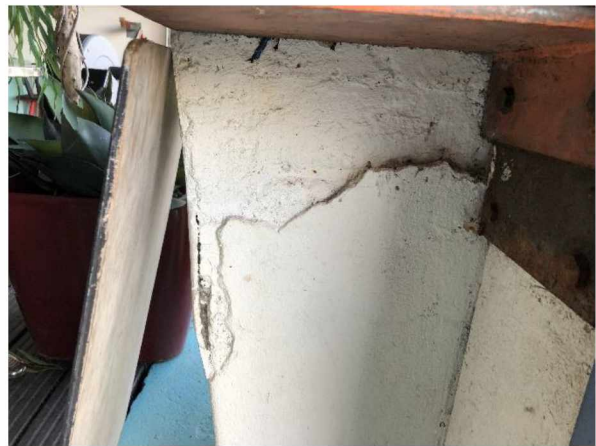
Foto 20: Deels verdwenen afwerklaag van kolom.
