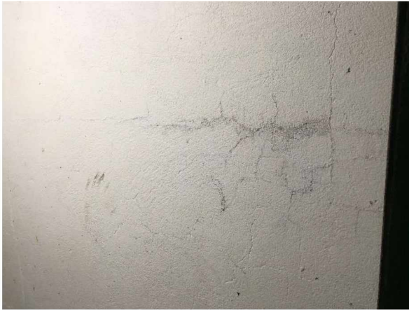
Foto 47: Scheuren in afwerklaag wand.
