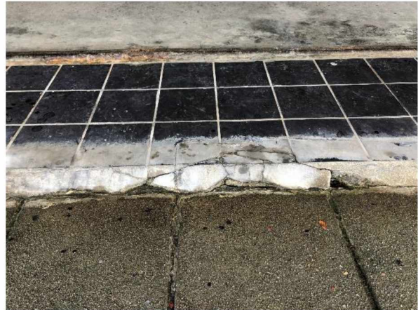
Foto 14: Losliggende cementgebonden opstand bij ingang.
