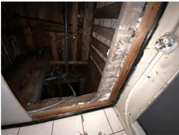
Divers leidingwerk boven de plafonds
