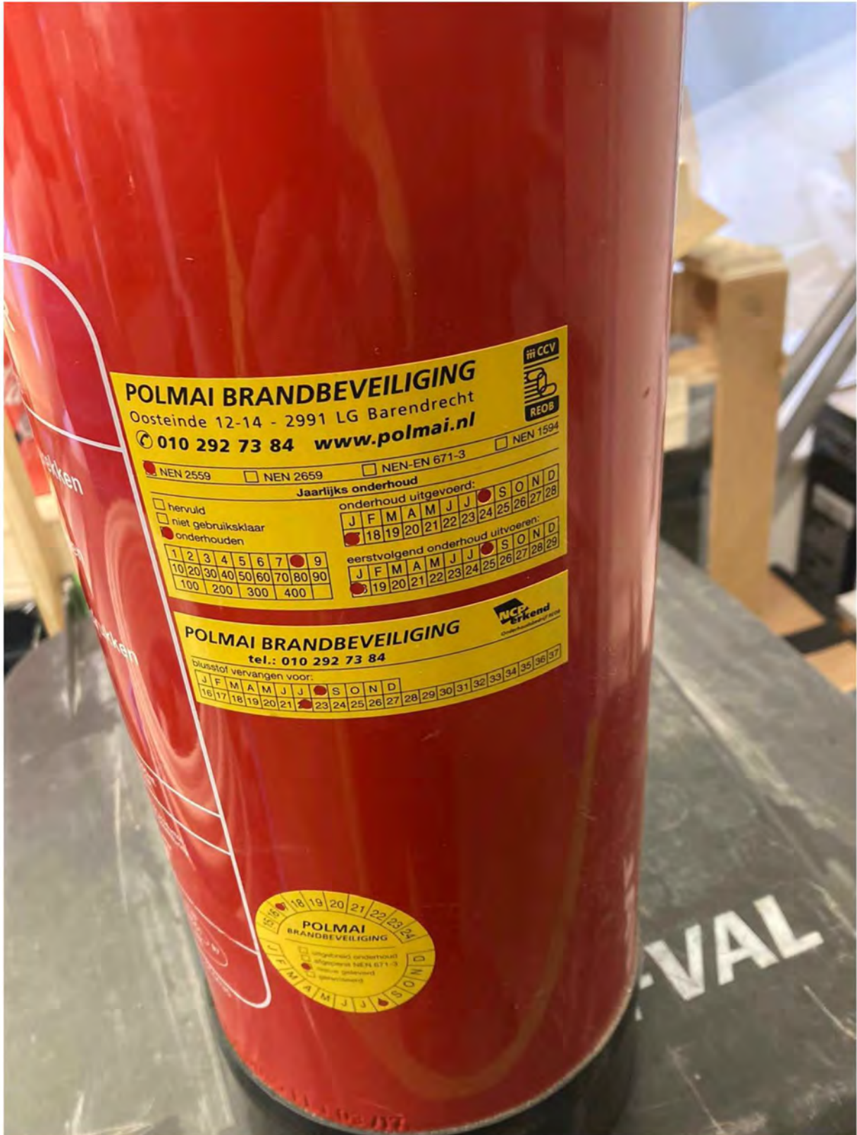
Foto gemaakt op 16-5-2024. Losse brandblusser niet gekeurd en niet opgehangen in de opslag.
