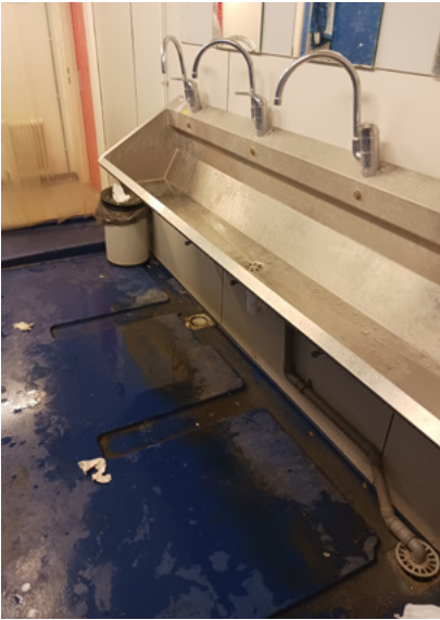
Afbeelding 10. Wastafels in no Assen (14 juni 2023)
