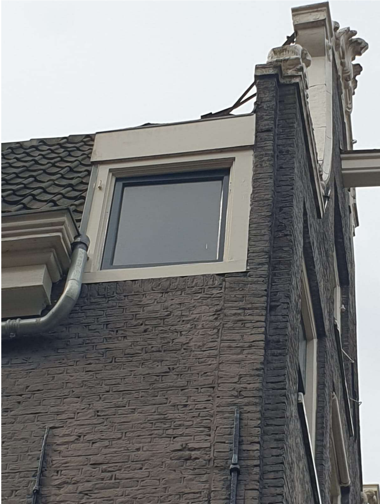
Foto 6 kozijn zijgevel voorzijde, 2 scharnieren links aanwezig/zichtbaar
