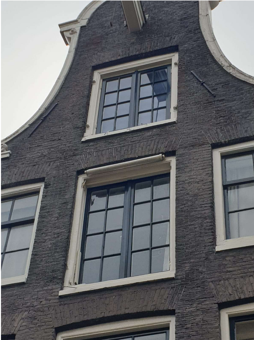
Foto 5 kozijnen 2 en 3 hoog in voorgevel. 4 x scharnieren 3 hoog aanwezig/zichtbaar. Kozijn 2 hoog heeft nog 1 scharnier (linksboven) overige 3 scharnieren niet meer aanwezig.
