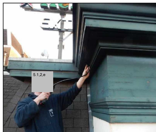
Figuur 11. Inspectie met behulp van endoscoop.
