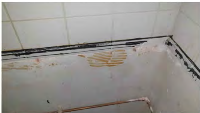
F11 Andreas Bonnstraat 7H Recent aangebracht tegelwerk
