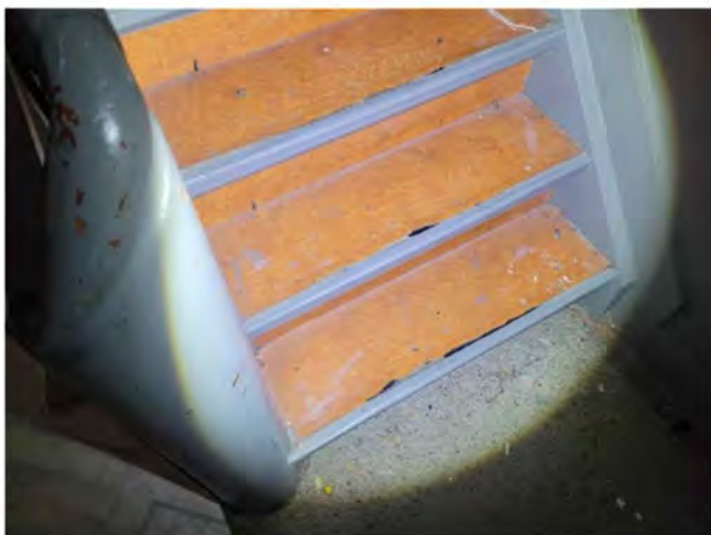
F16 Andreas Bonnstraat 15-1 Niet asbestverdacht vloerzeil op de trap
