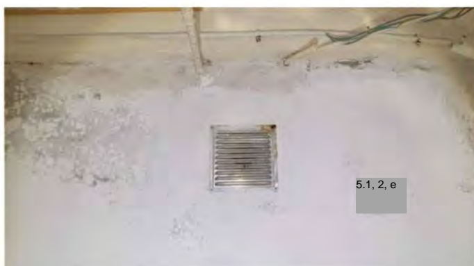
F07 Andreas Bonnstraat 17H Niet asbestverdachte doorvoer in de kelder
