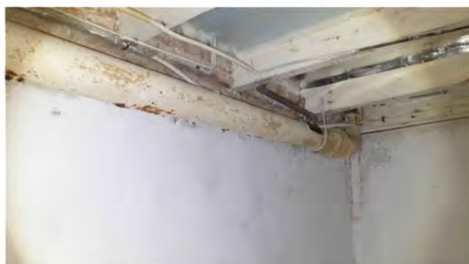
F08 Andreas Bonnstraat 17H Gietijzer buis in de kelder
