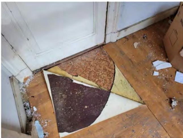
F4 Andreas Bonnstraat 7-1 Niet asbestverdachte vloerzeilen
