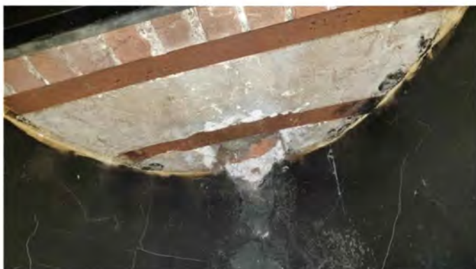
F11 Andreas Bonnstraat 9H Geen asbestverdachte toepassingen ter hoogte van de schouw
