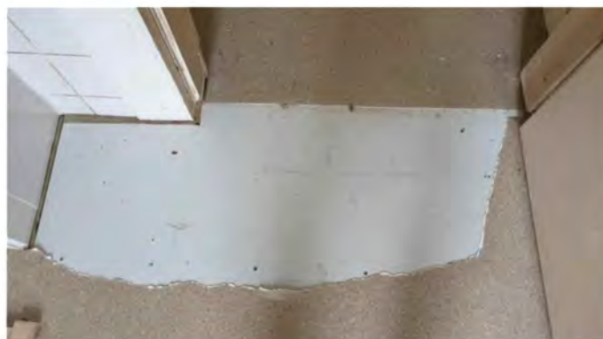
F1 Andreas Bonnstraat 15-3 Niet asbestverdachte Fermacell vloerplaten
