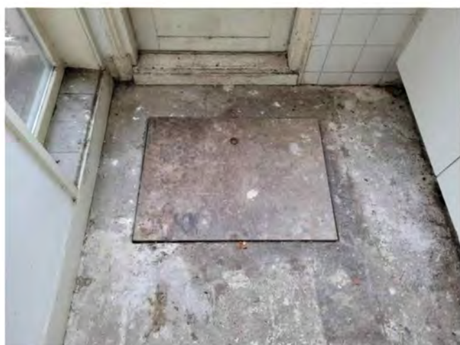
F07 Andreas Bonnstraat 11H Niet asbestverdacht vloerluik
