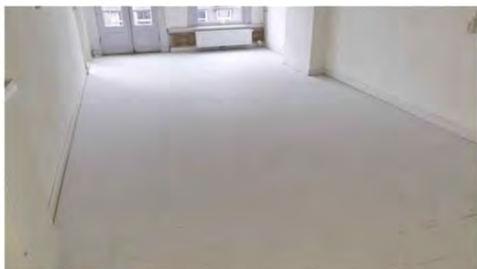
F2 Andreas Bonnstraat 15-3 Niet asbestverdachte Fermacell vloerplaten
