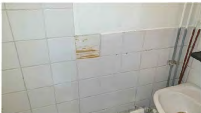
F07 Andreas Bonnstraat 9H Recent aangebracht tegelwerk
