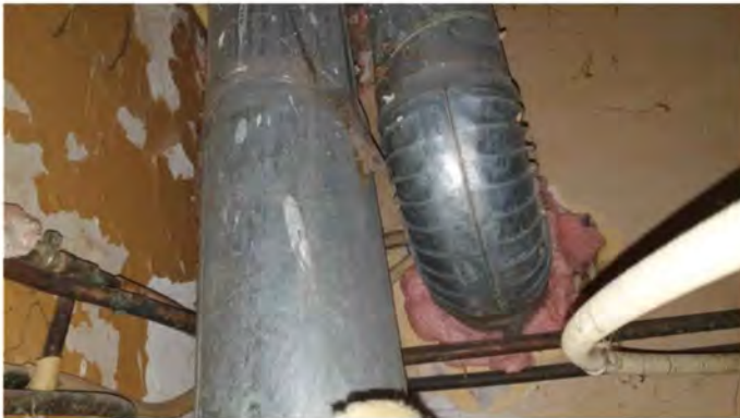
F04 Andreas Bonnstraat 15H Metalen buizen boven het plafond van de keuken
