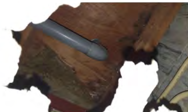
F07 Andreas Bonnstraat 15-1 Geen asbestverdachte toepassingen boven verlaagd plafond
