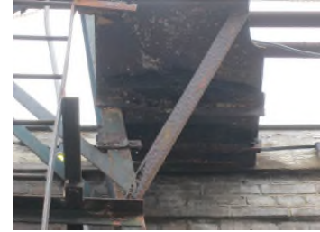
Corrosie met materiaalafname
