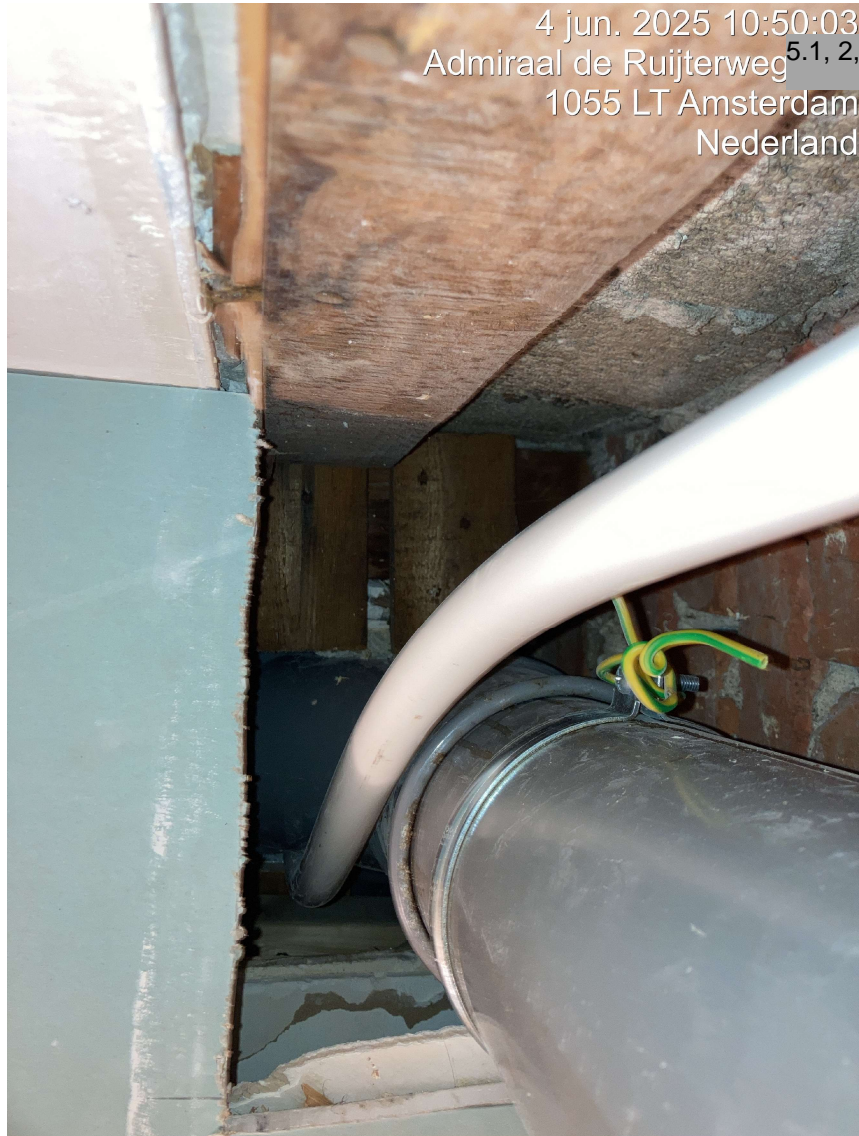
Scheidingsconstructie rondom de standleiding niet brandwerend bekleed.
