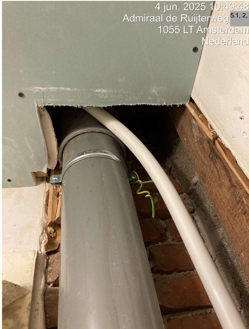
Scheidingsconstructie rondom de standleiding niet brandwerend bekleed.
