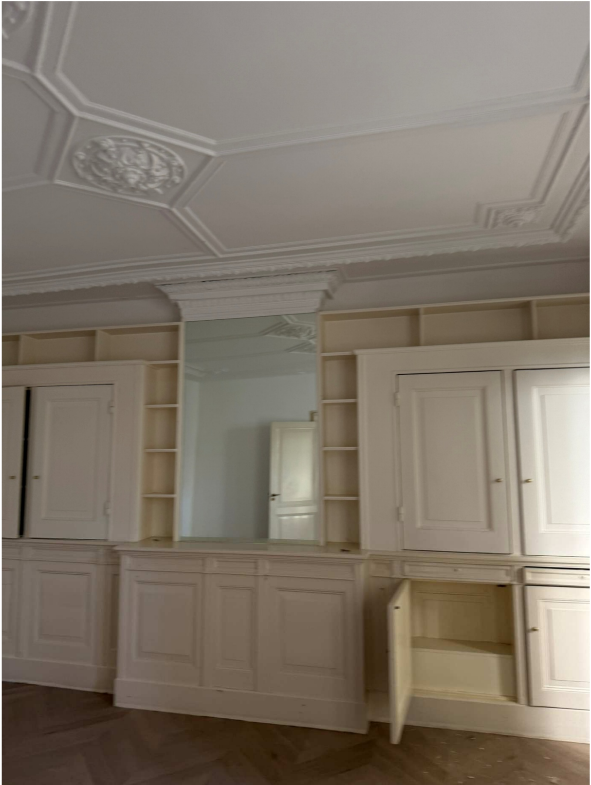
Kastenwand als aangetroffen op 12 maart 2025
