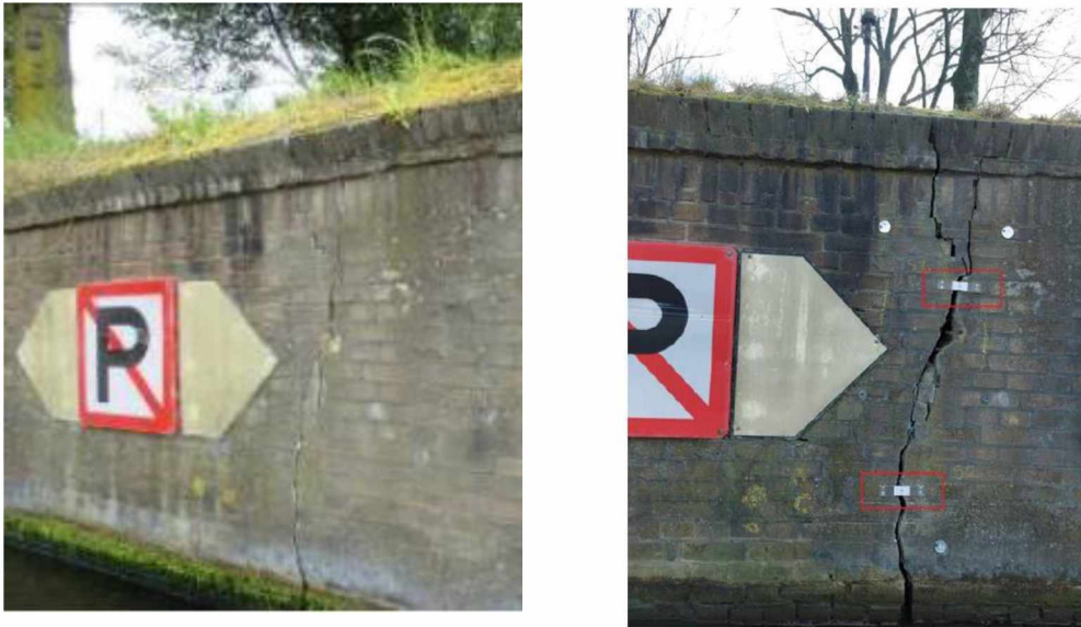
Figuur 3-4 - Scheurvorming, toestand inspecties, nabij paalrij 75. Links een opname uit 2017 en rechts uit 2022 .
