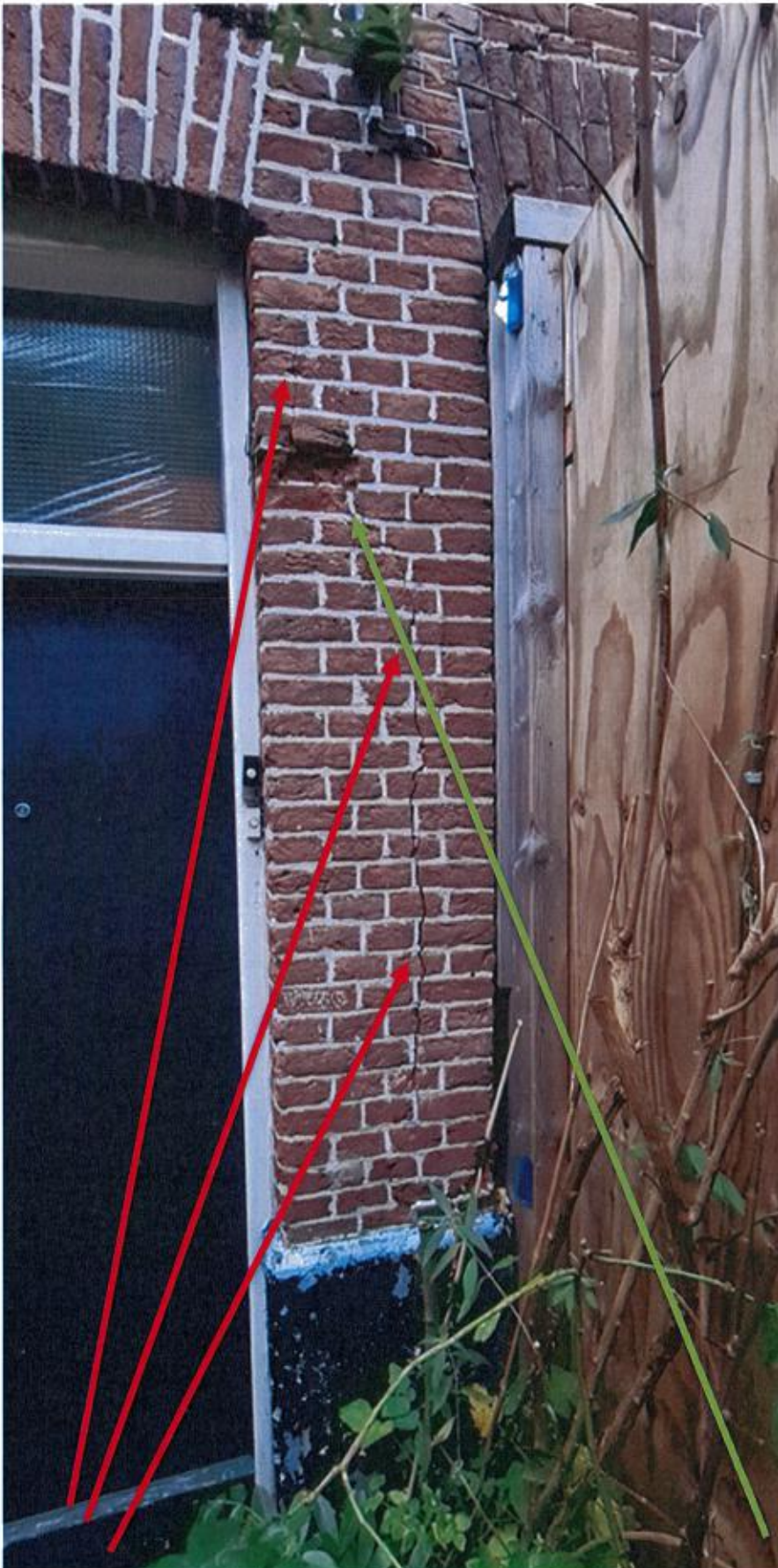
Gescheurde penant tussen de voordeuren van nr. 36 en nr. 38 en uitgevallen metselwerk
