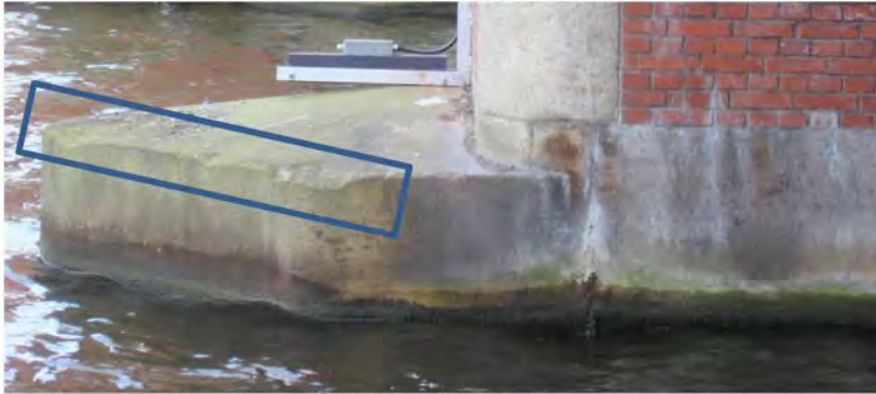
Foto 31 aanvaarschade schampblok pijlerkop.
