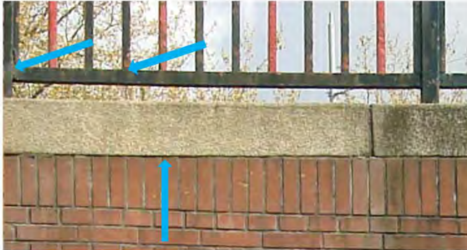
Foto 35: losliggende blokken, aansluitingen spijlen en regels ernstig gecorrodeerd.
