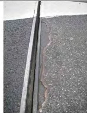
Detailfoto 18: Ontbrekende slijtlaag wegdek
