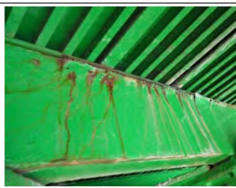
Detailfoto 9: Conserveringsafname en corrosie
