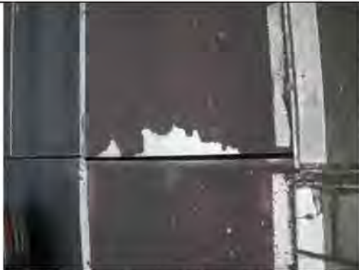
Detailfoto 21: Ontbrekende slijtlaag fietspad achterhar rechts
