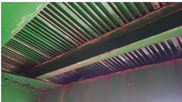
Detailfoto 10: Conserveringsafname en corrosie
