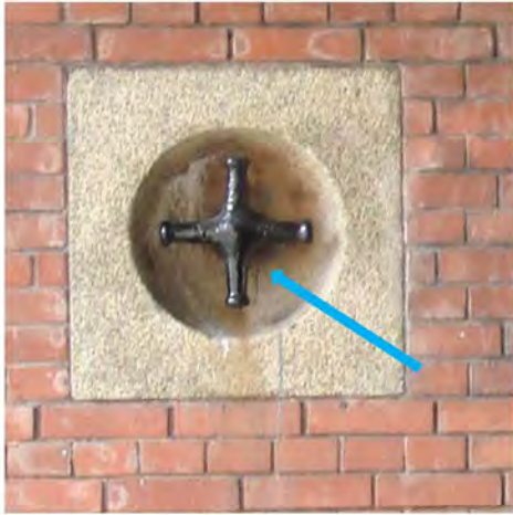
Foto 43. Haalkom met gietijzeren kruisvormig haalkomijzer. (aansluiting haalkomijzer aan het natuursteen sterk gecorrodeerd)
