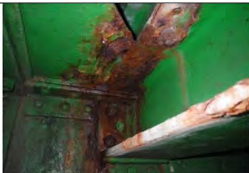
Detailfoto 12: Conserveringsafname en corrosie
