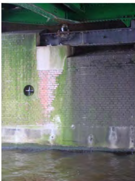
Foto 27: algen en roetvervuiling.
