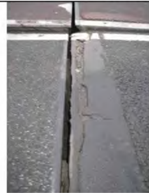
Detailfoto 20: Schade voegovergang voorhar
