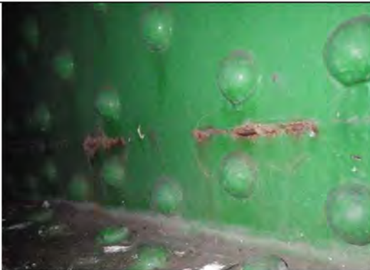
Detailfoto 16: Conserveringsafname en corrosie profielnaad langsligger
