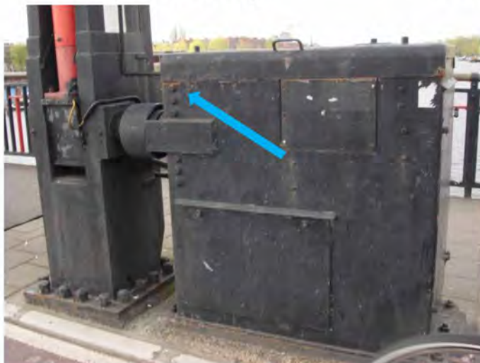
Foto 46: voet slagboom en slagboomkast (div. plaatsen aanslag. gecorrodeerd). verfsysteem is matig.
