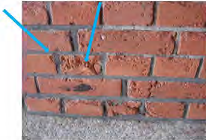
Foto 30: te hard voegwerk (donkere voegen) en mechanische schade
