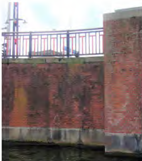
Foto 36: geheel matig tot slecht. Voegwerk metselwerk
