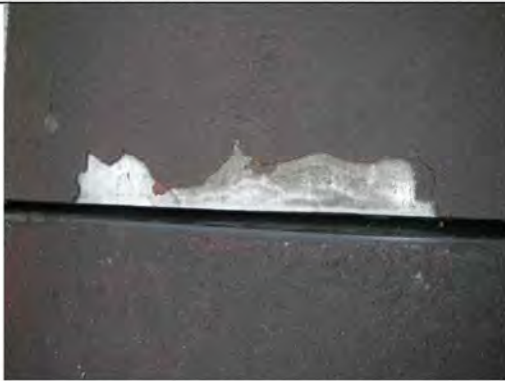
Detailfoto 17: Ontbrekende slijtlaag fietspad links
