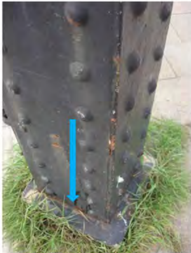
Foto 44: voet lantaarn (aanslag. gecorrodeerd). verfsysteem is matig.
