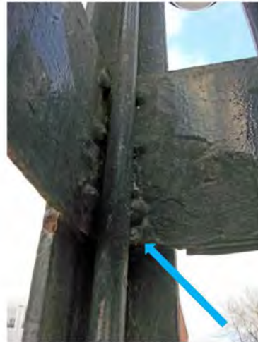
Foto 45: koppelplaat lantaarn. (aansluitingen gecorrodeerd). verfsysteem is matig.
