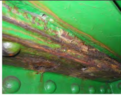
Detailfoto 15: Conserveringsafname, corrosie en lichte materiaalafname
