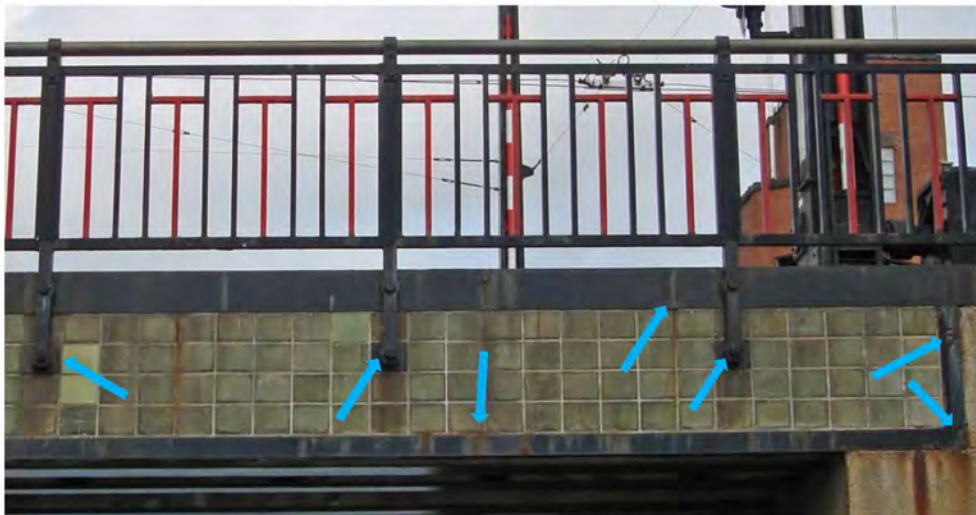
Foto 41: leuning Amstelzijde zuid (hoeklijnen en bevestigingsbeugels sterk gecorrodeerd)
