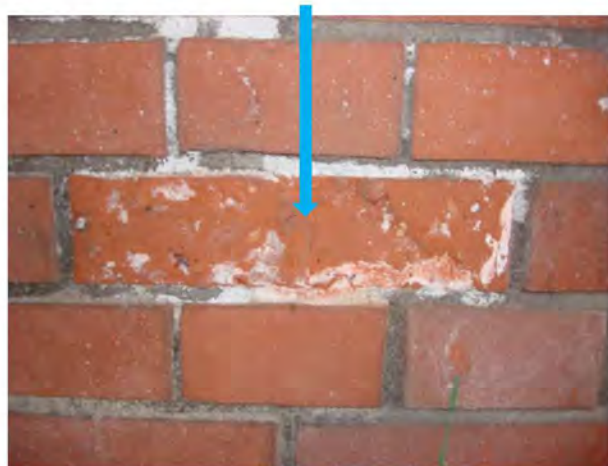
Foto 23: beschadiging steenoppervlak a.g.v. zoutuitbloei.
