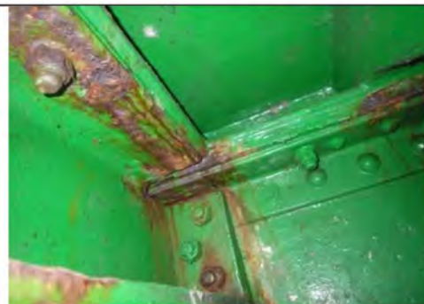
Detailfoto 13: Conserveringsafname en corrosie
