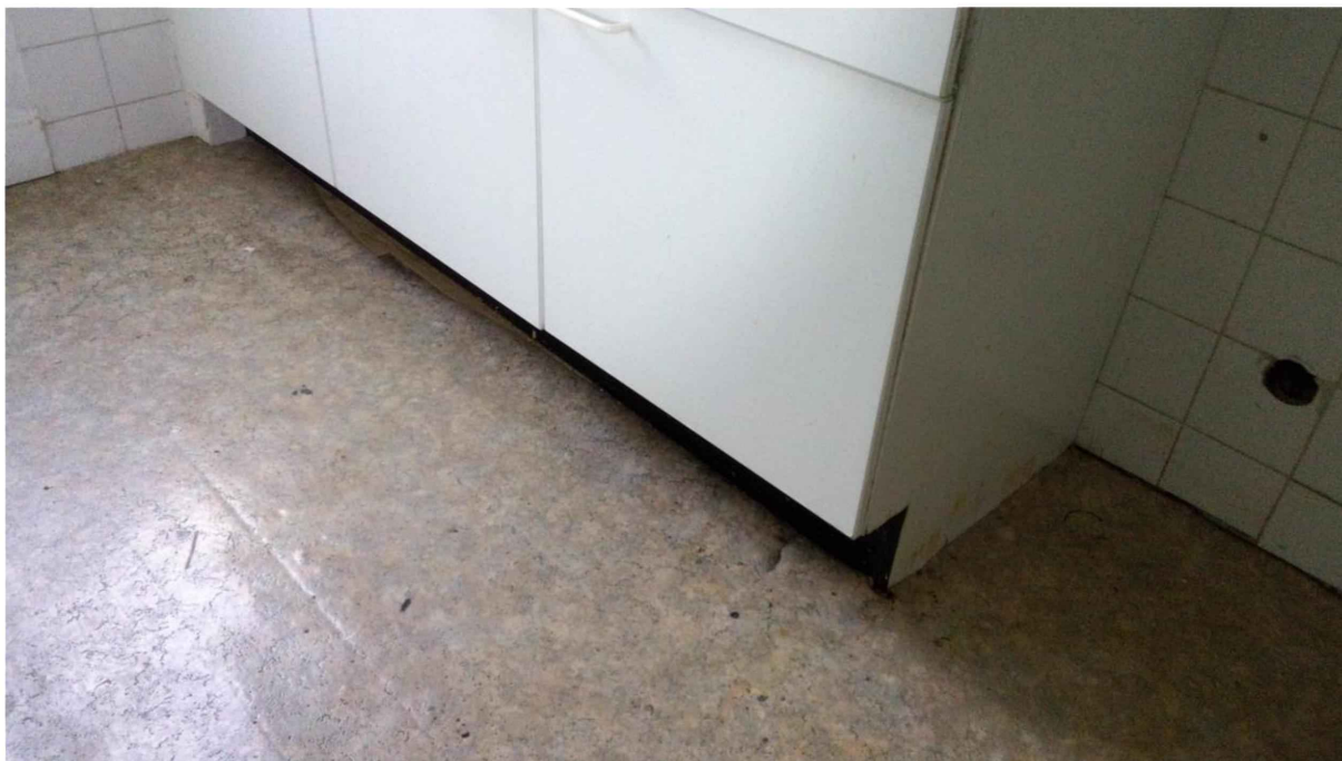
Foto F01 Beperking Onder het keukenblok
