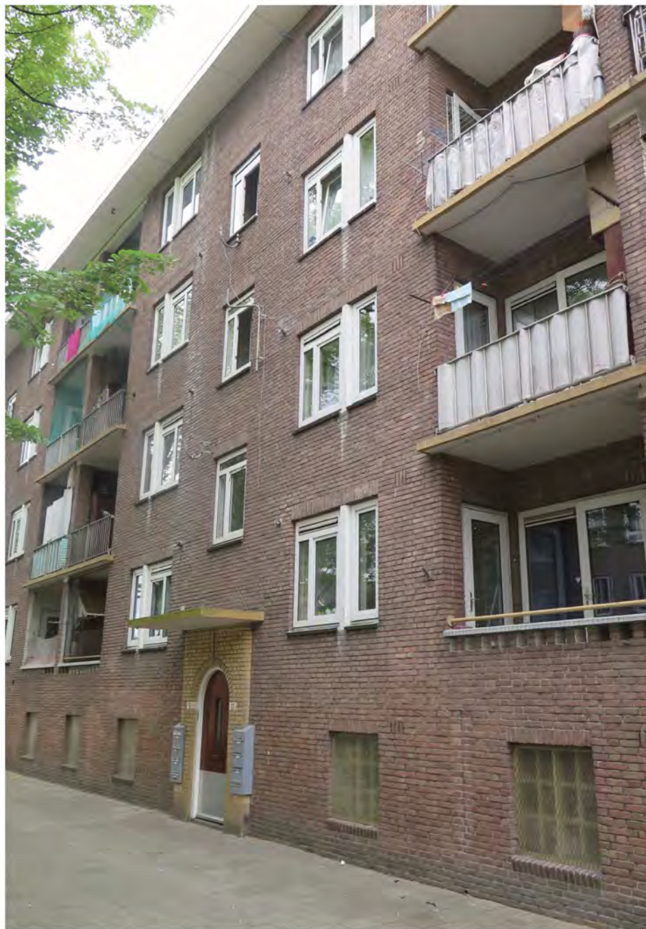
Witte strepen op het metselwerk/balkons dichtgezet met doeken - 2018
