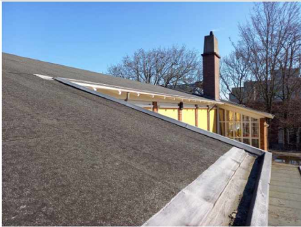
Opmerkingen coating op dakbedekking als goot
