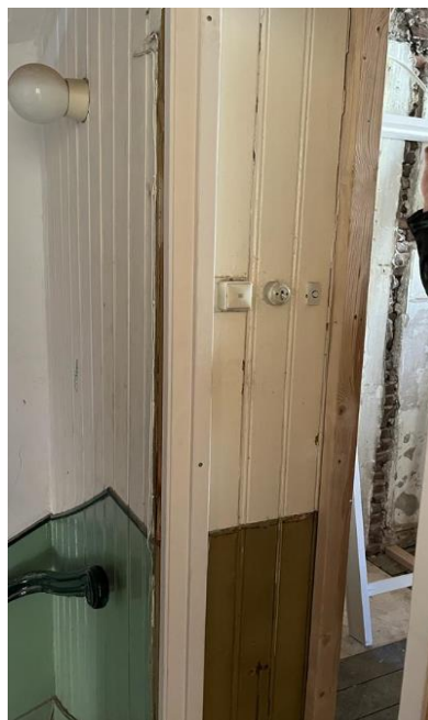
Figuur 40. Ventilatieschacht halzijde
