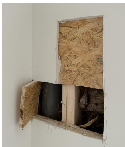
Figuur 33a. standleiding/ontluchting door voorzetwand op de 2 e verdieping
