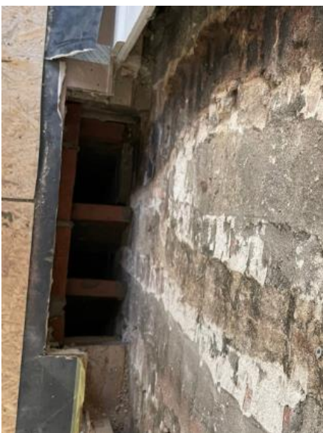
Figuur 27a. interne leidingen schoorsteen 2 e verdieping
