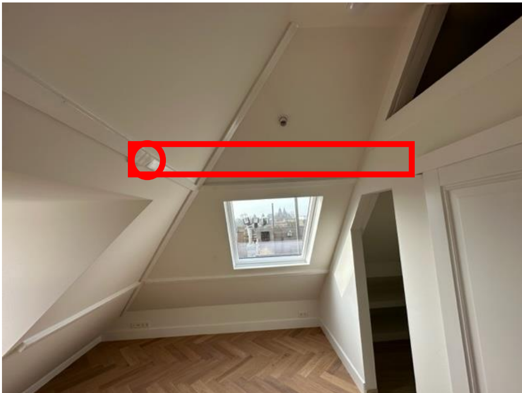
Figuur 45. Gemarkeerde delen betreft de intern verwijderde hijsbalk. Rond gemarkeerd is de plaats waar deze hijsbalk is afgezaagd.
