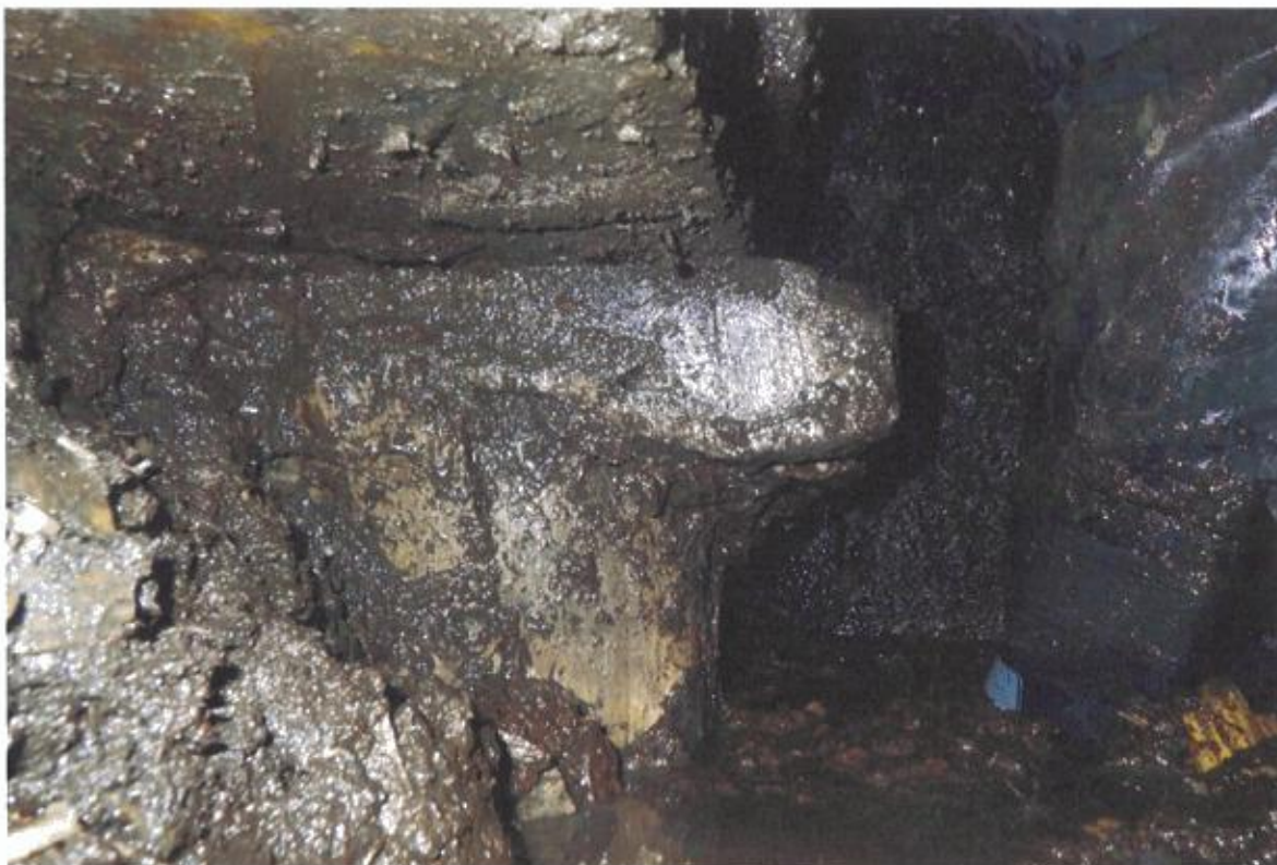
langshout 1, kesp 2 en paal 2 (kesp 2 is 50% samengedrukt)
