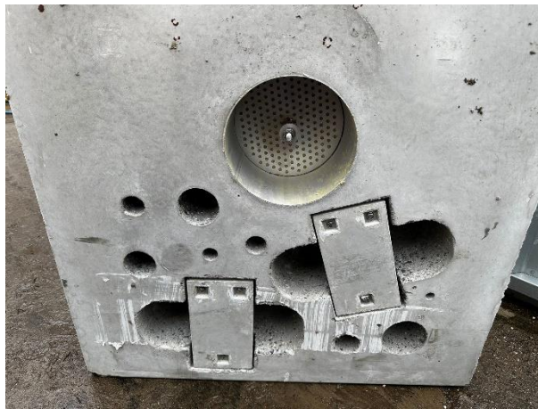
Figuur 12: Foto van de voorzieningen in het betonelement. De bovenste sparing verzorgt de waterdoorlatendheid.
