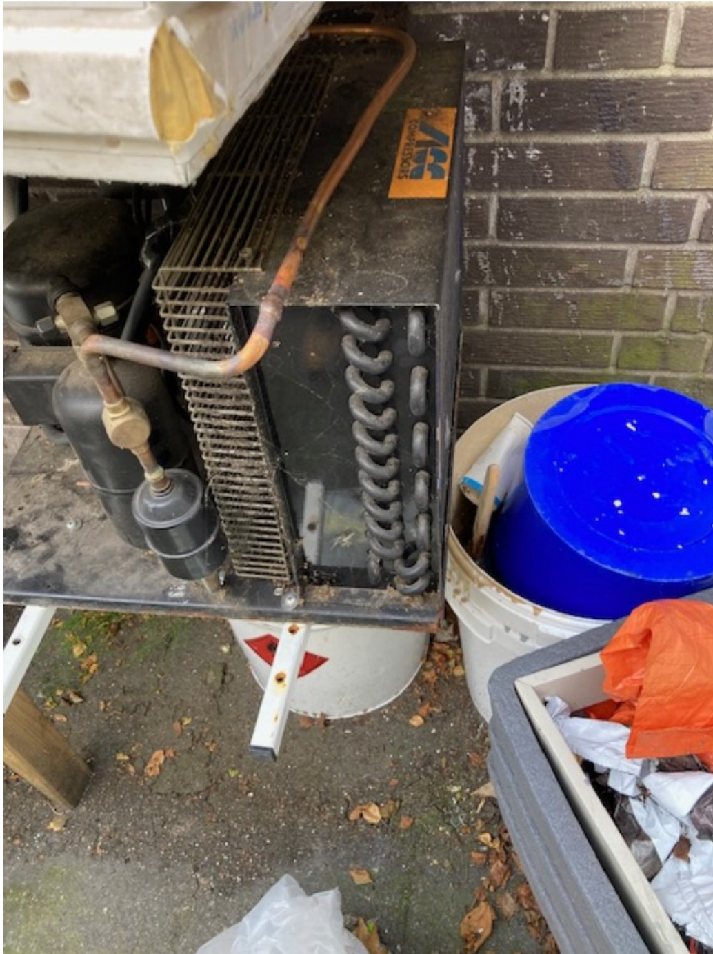
Compressor zonder bescherming (een plaat houdt tegen de regen), Inpandig of in een kast zou een hoop kunnen schelen!
