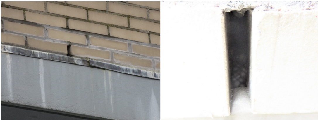
Figuur 3.1 Open stootvoegen in het Strawinskyhuis (links) met aanwezigheid van isolatiemateriaal (rechts).
