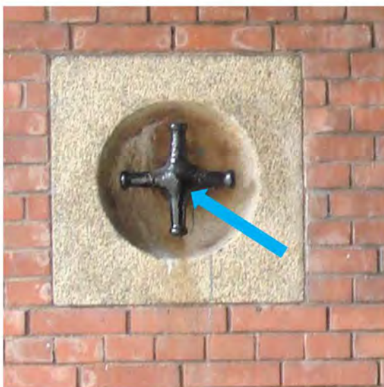
Foto 41. Haalkom met gietijzeren kruisvormig haalkomijzer. (aansluiting haalkomijzer aan het natuursteen sterk gecorrodeerd)
