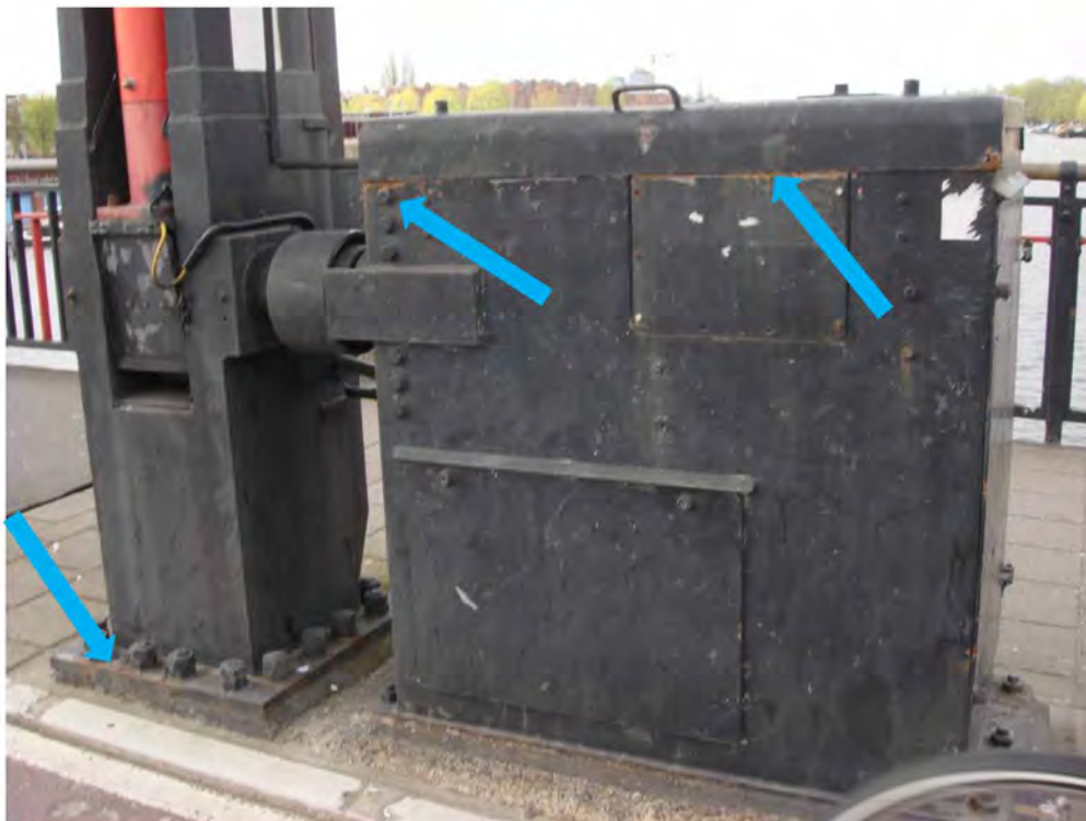
Foto 44: voet slagboom en slagboomkast (div. plaatsen aansl. gecorrodeerd). verfsysteem is matig.
