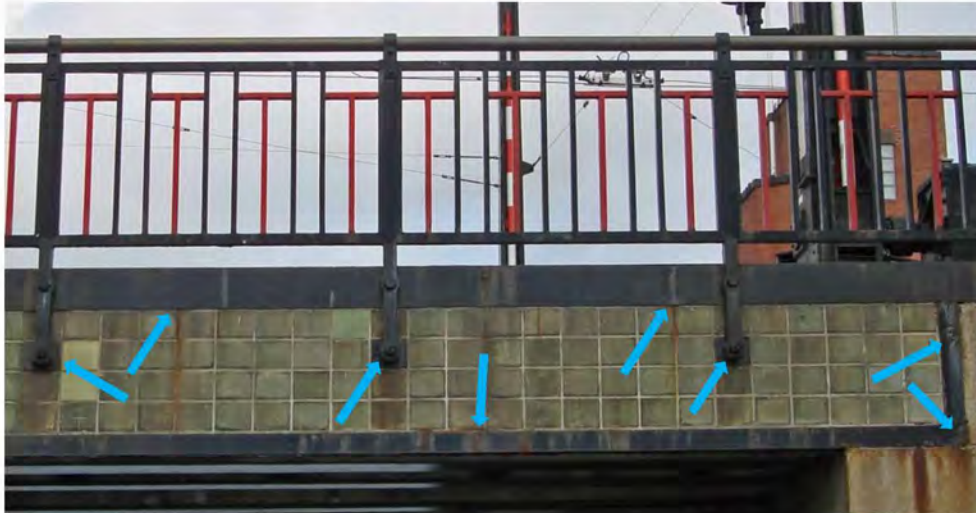
Foto 39: leuning Amstelzijde zuid (hoeklijnen en bevestigingsbeugels sterk gecorrodeerd)
