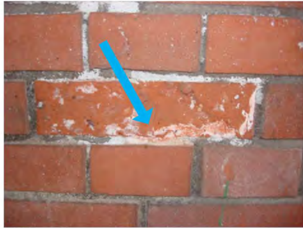
Foto 21: beschadiging steenoppervlak a.g.v. zoutuitbloei.
