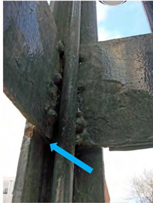
Foto 43: koppelplaat lantaarn. (aansluitingen gecorrodeerd). verfsysteem is matig.
