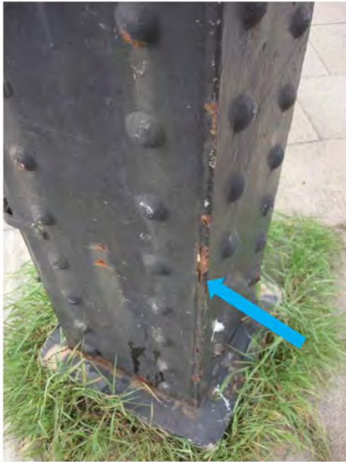
Foto 42: voet lantaarn (aansl. gecorrodeerd). verfsysteem is matig.
