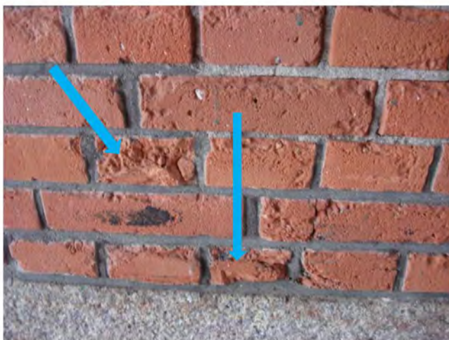
Foto 28: te hard voegwerk (donkere voegen) en mechanische schade
