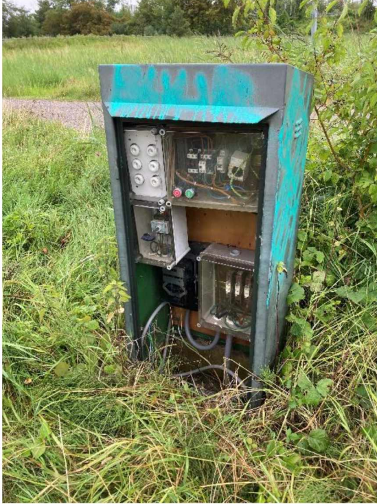
ONTBREKENDE DEUR VAN ELECTRAKAST
