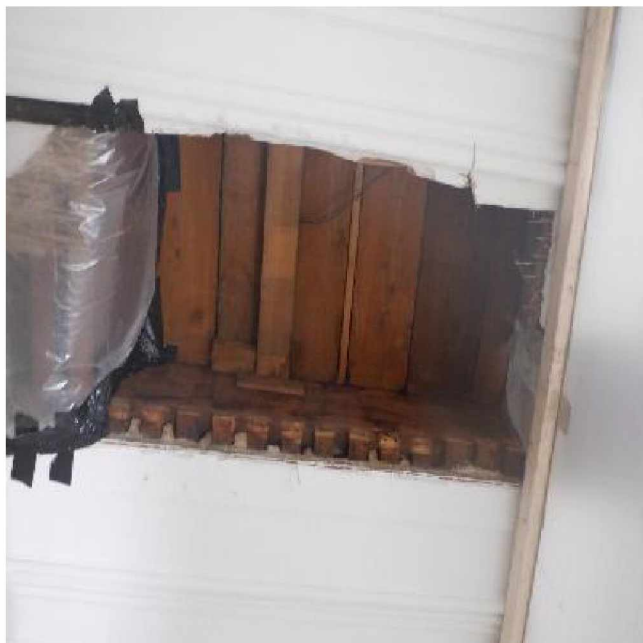
plafond na sanering toepassing
