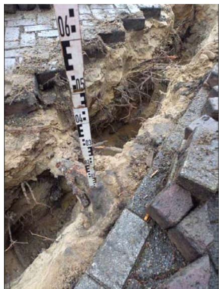
Oppervlakkige, weglappende gestelwortel richting rijbaan
