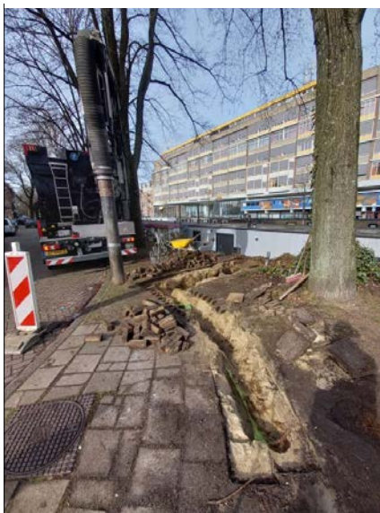
Voorzijde, beperkt haarwortels door graafwerk glasvezel
