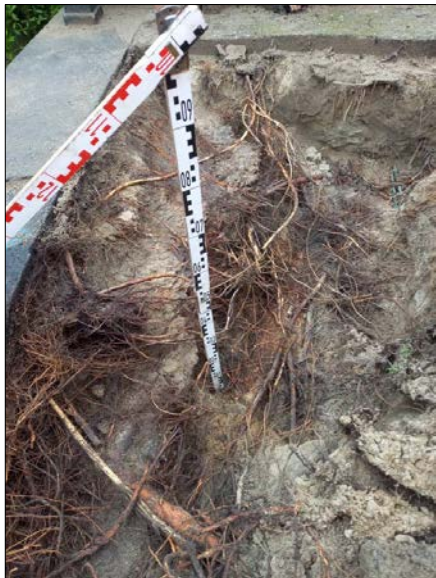
Zeer dikke gestelwortels en oppervlaking intensieve haarbeworteling parallel aan kade.
