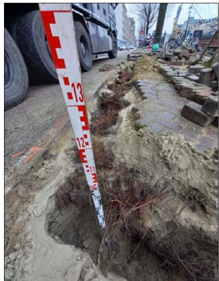
Zeer intensief, oppervlakkig en grillig wortelpakket aan straatzijde.
