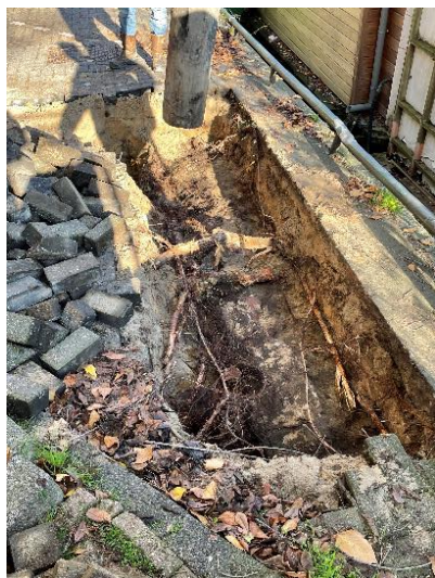
Stabiliteitswortels zichtbaar in eerste 50 cm onder maaiveld op oude kademuurfundering
