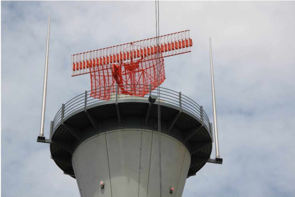
Figuur 70 De secundaire radarantenne gemonteerd op de STAR 2000 primaire radarantenne van de TAR West, bestaande uit 35 radar elementen.
