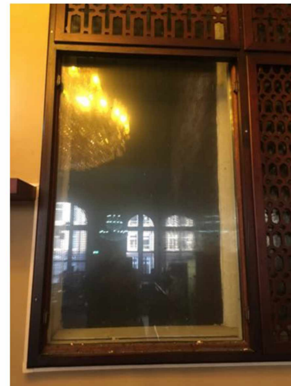
kozijn achter het scherm met zicht op houten plaat
