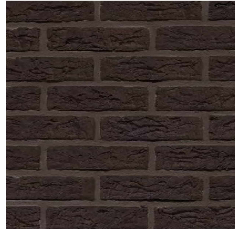
Nieuwe wanden met minerale steenstrips afgewerkt: Vergelijkbare steen, andere formaat en steenverband en andere kleur voegwerk
