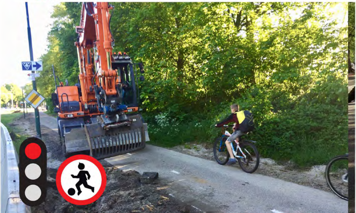
Zorg altijd voor veilige routes. Werk met materieel uitsluitend onder begeleiding van verkeersregelaars op in gebruik zijnde fietspaden.
