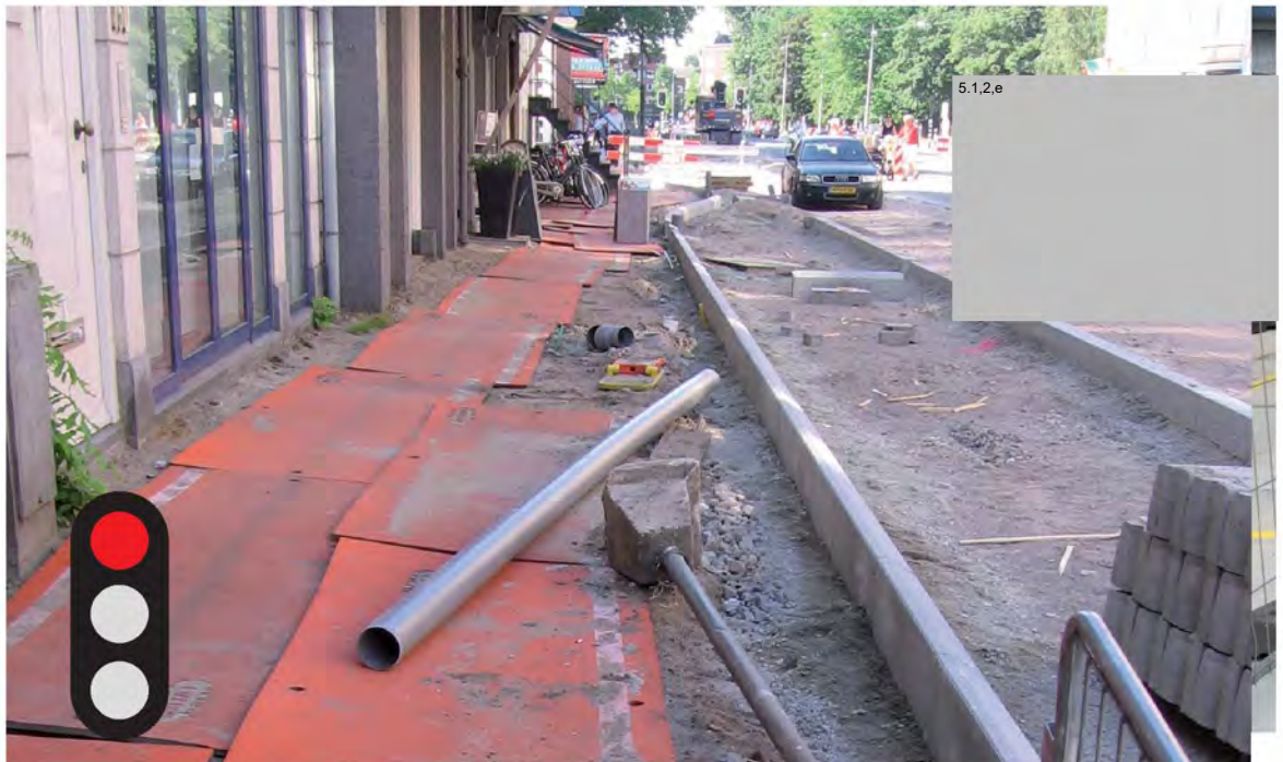
Behoud doorgangruimte. Geen rommel op de looproute. Leg loopschotten altijd ordelijk neer.
