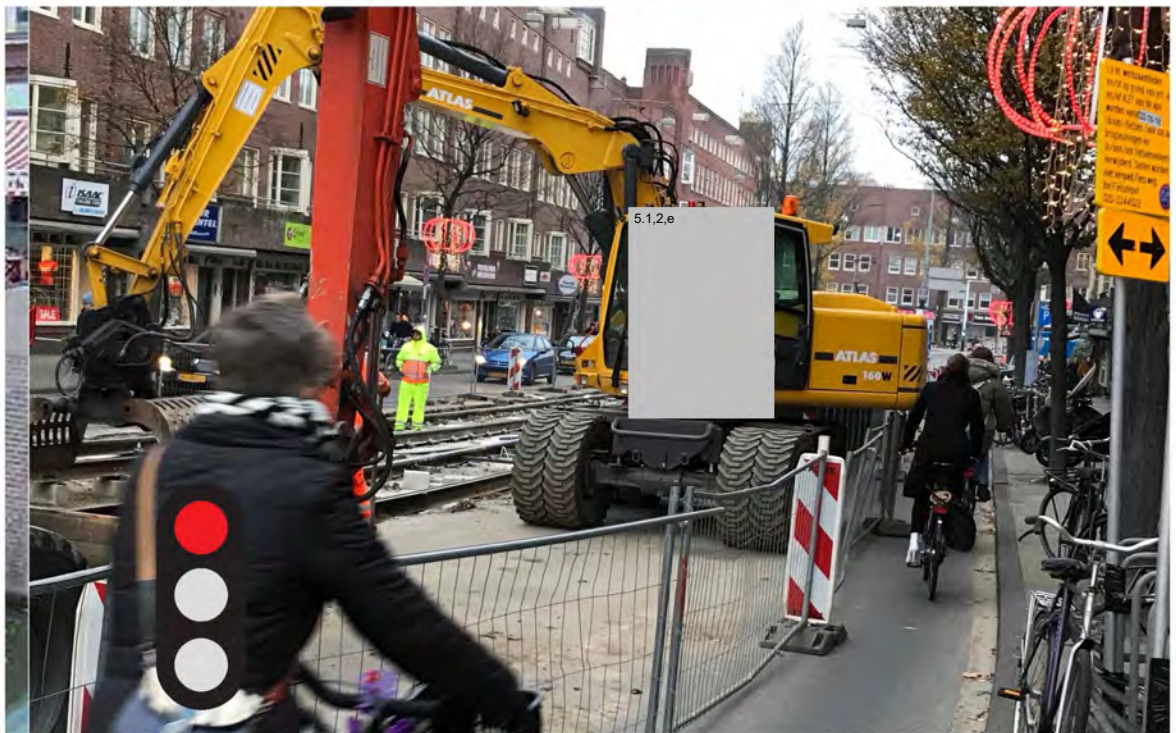
Zorg dat (fiets)verkeer niet in de gevarezone komt. Breedte fietspad onvoldoende.
