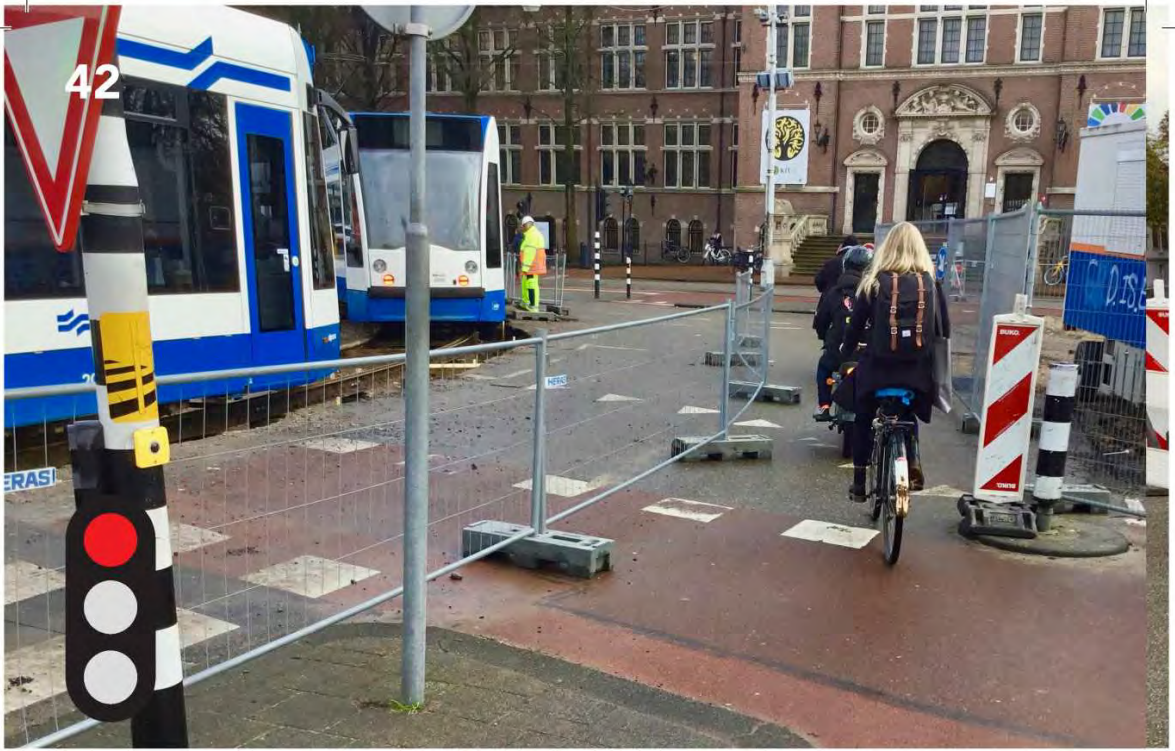
Voeten van het bouwhek dwars op de tijdelijke fietsroute waardoor mogelijk aanrijdgevaar ontstaat. Breedte van het fietspad onvoldoende.
