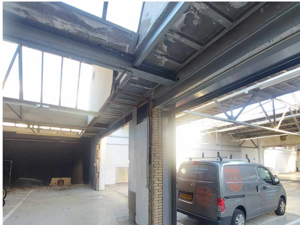
gebouwdeel C/D Het linkerdeel toont de huidige staat van gebouwdeel C met het sheddak. Ook toont de foto de aansluiting tussen de oude constructie en de later toegeegde voorzetwand van metselwerk.
