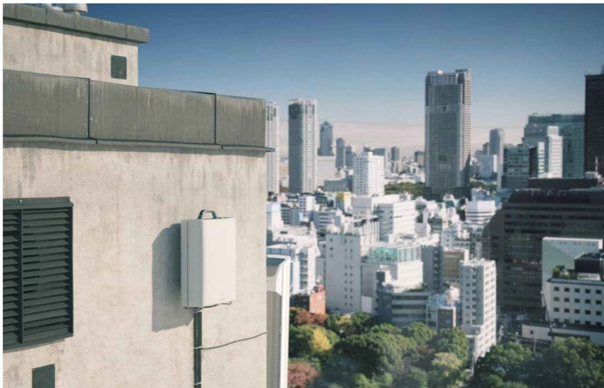
Afbeelding 13 Foto Ericsson RBS 6302, welke onderaan de antenedragers gemonteerd worden.
