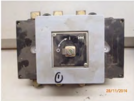
Toelichting bij foto 1: Schakelaar HH type S22 400A
