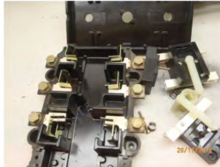
Toelichting bij foto 2: Schakelaar HH type S22 400A
