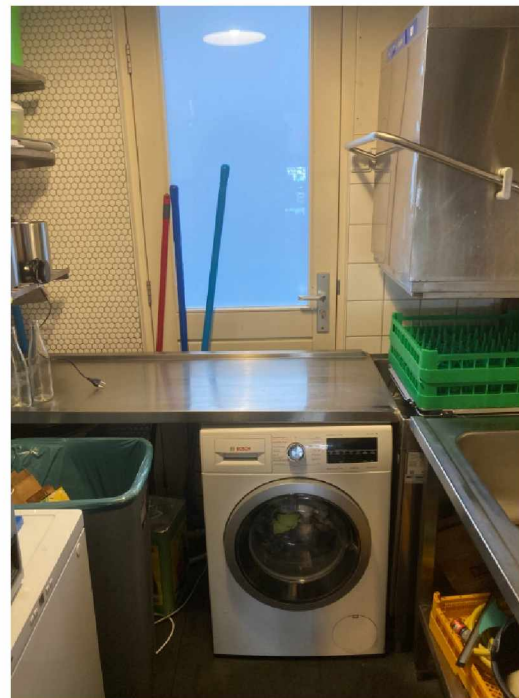
Binnenzijde van het restaurant kozijn / deur Deur is nooit in gebruik i.v.m. obstakels.
