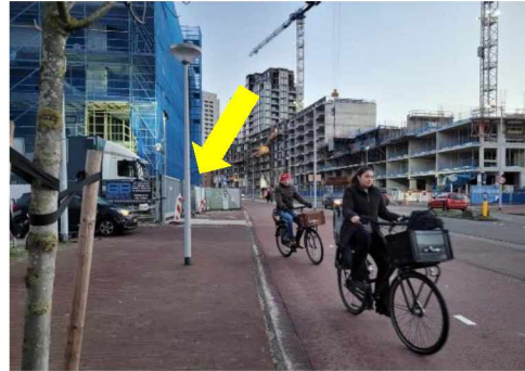
Afbeelding 10: Beperkt zicht door bouwhekken aan de Elzenhagensingel.
