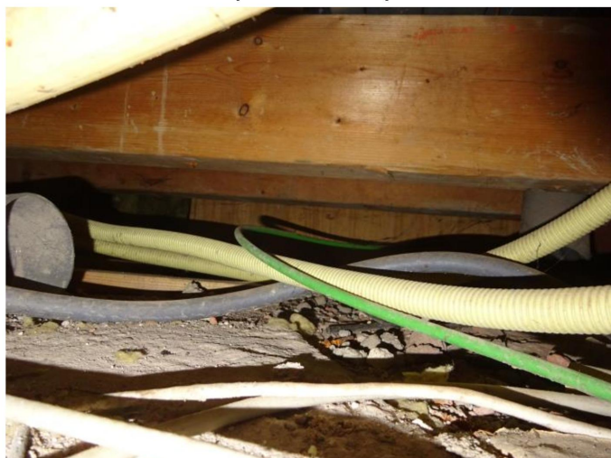
Kruipruimte met PVC riolering
