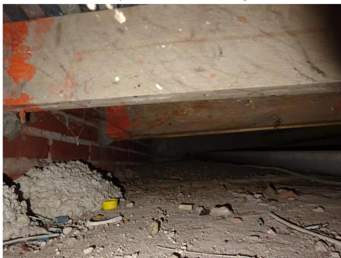
Kruipruimte met PVC riolering
