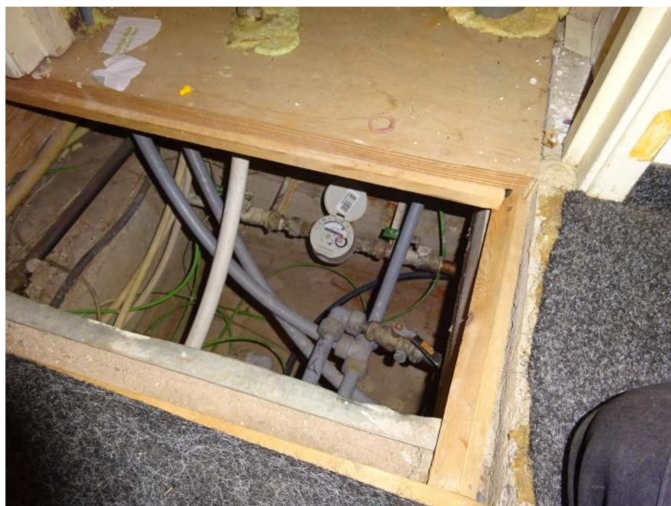
Kruipruimte met PVC riolering
