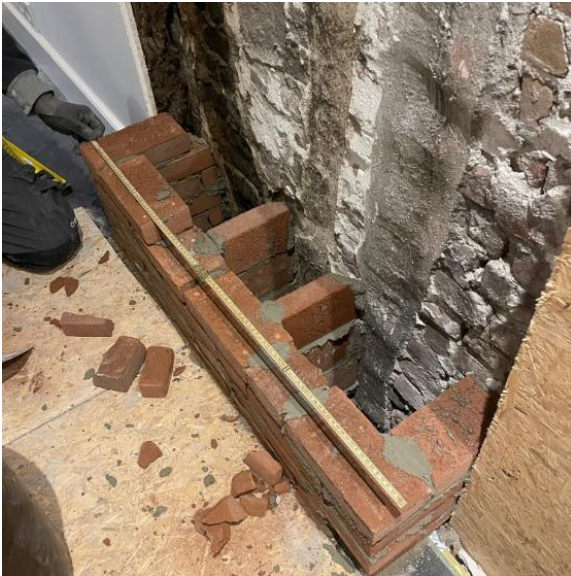
Figuur 27b. interne leiding teruggeplaatste schoorsteen op de 2 e verdieping
