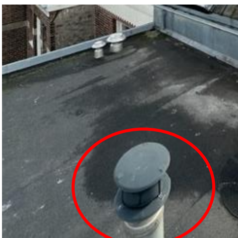
Figuur 33. Uitmonding van de standleiding/ontluchting op het dak ter hoogte van de zolderverdieping
